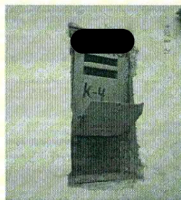
Foto N° 50 Deficiencia: ELN-046-4-2014-057. Suministro: [REDACTED] Tipificación: 8016
