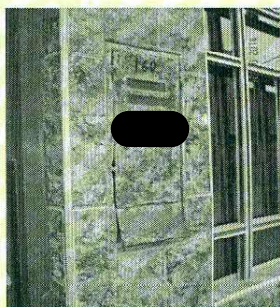
Foto N° 55 Deficiencia: ELN-046-4-2014-063. Suministro: [REDACTED] Tipificación: 8016.
