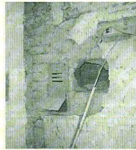
Foto N° 15 Deficiencia: ELN-046-4-2014-015. Suministro: [REDACTED] Tipificación: 8016.
