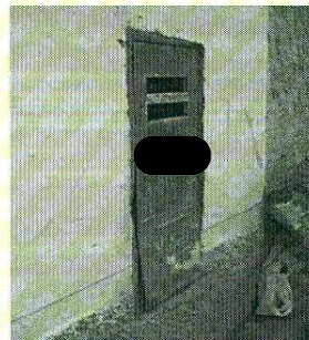
Foto N° 57 Deficiencia: ELN-046-4-2014-065. Suministro: [REDACTED] Tipificación: 8016
