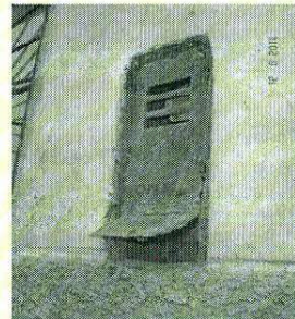
Foto N° 54 Deficiencia: ELN-046-4-2014-062. Suministro: [REDACTED] Tipificación: 8016
