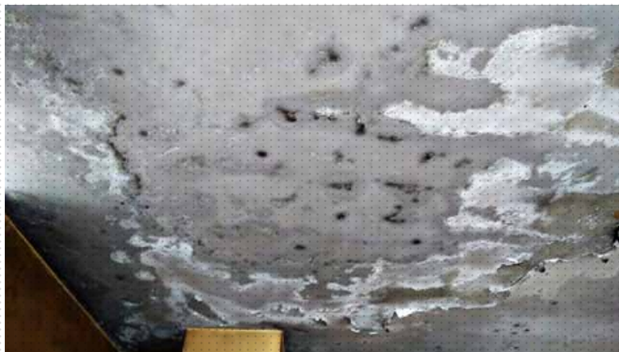
Foto: Techo de la cocina del centro juvenil de Trujillo. Supervisión preventiva multidisciplinaria 2019 Fuente: MNPT.
