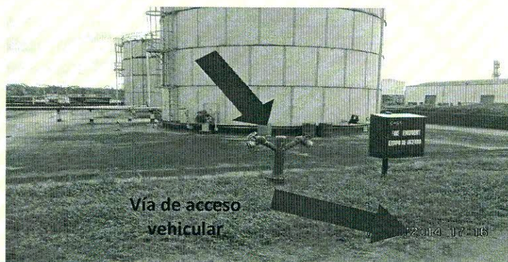
Hidrante ubicado frente al área de tanques, no cuenta con protección a pesar de que se encuentra cerca de vía de acceso vehicular.
