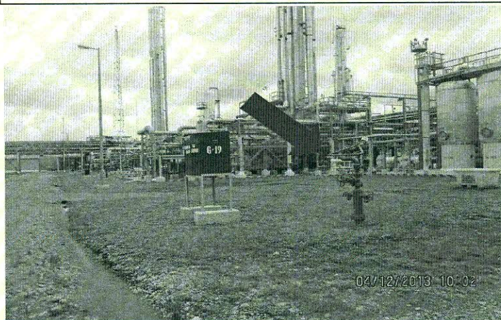
Hidrate ubicado cerca del compresor #7, no cuenta con protección a pesar que se encuentra cerca de vía de acceso vehicular.
