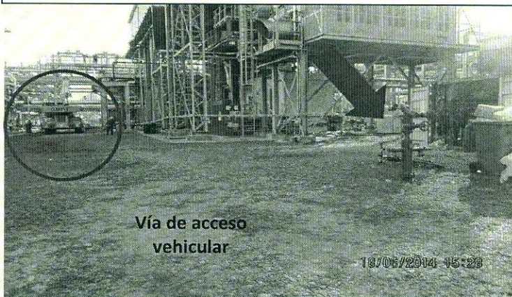
Hidrante ubicado frente al turbocompresor Nuevo Pignone #5, no cuenta con protección. Se observa una grúa al fondo que transita por la zona.
