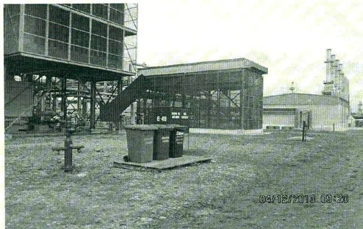
Hidrate ubicado cerca del compresor #6, no cuenta con protección a pesar que se encuentra cerca de vía de acceso vehicular.
