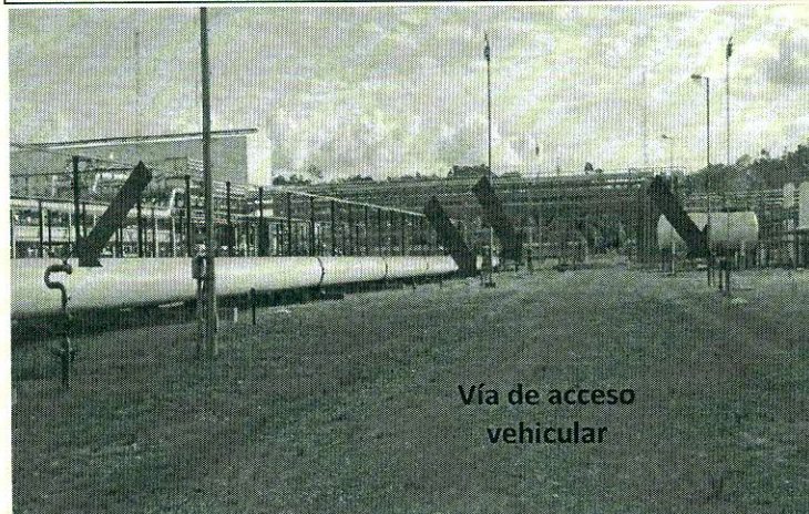
Panorámica en el slug cutter señalizando los hidrantes sin protección a pesar que se encuentran en zona de tránsito vehicular.
