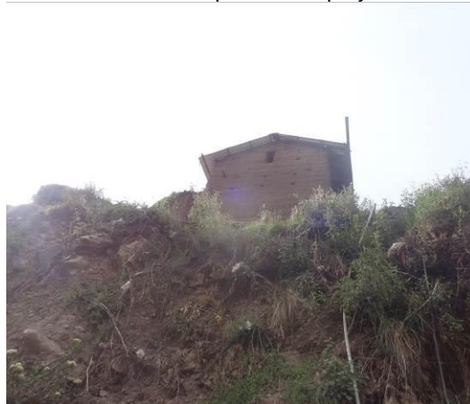
Vivienda afectada por el talud proyectado
