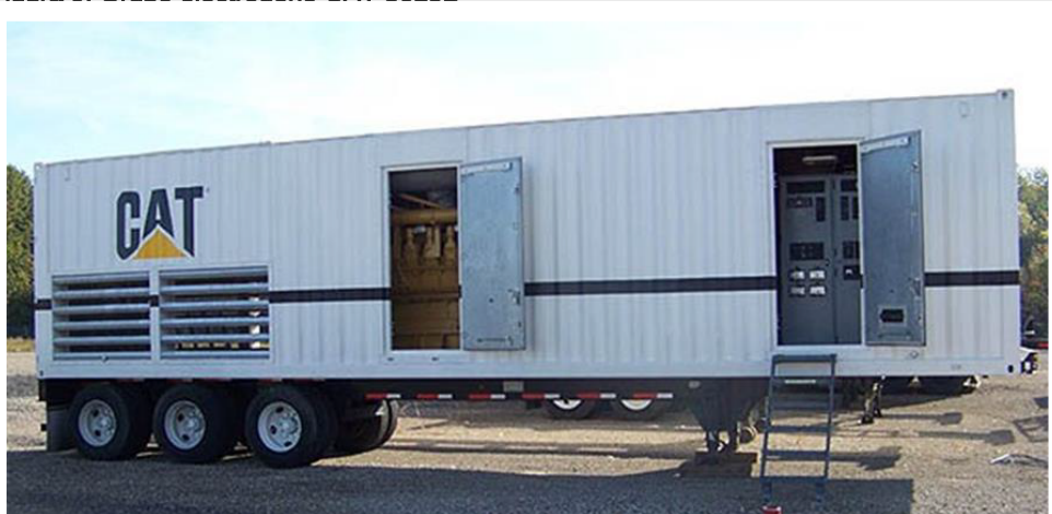
Figura 9. Grupo electrógeno CAT 3615B
