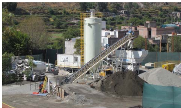
IMPLEMENTACIÓN DE PLANTA CONCRETERA (RENDIMIENTO HASTA 70 M3/HORA)
