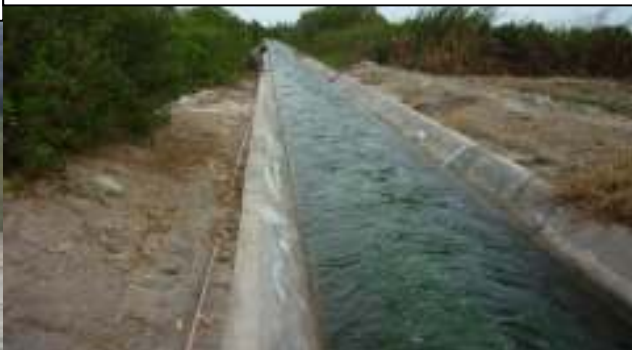
CANAL SAN JUAN DE CATAS, VALLE DE TAMBO III ETAPA
