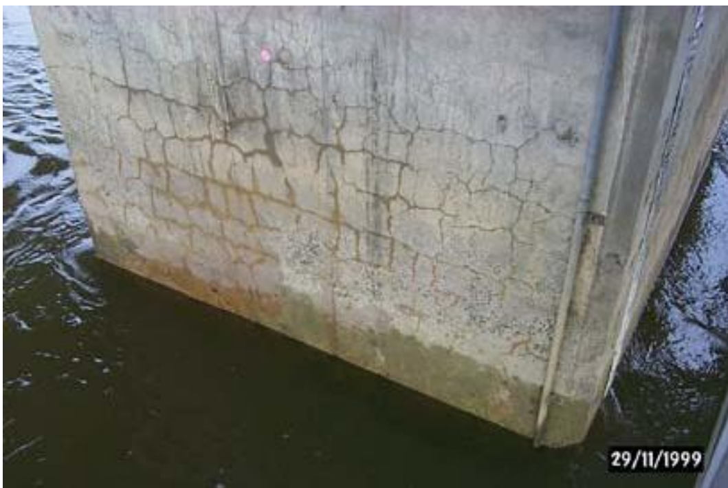
Figura 6: Fisuras producidas por DEF en Pilar de Puente [18]
