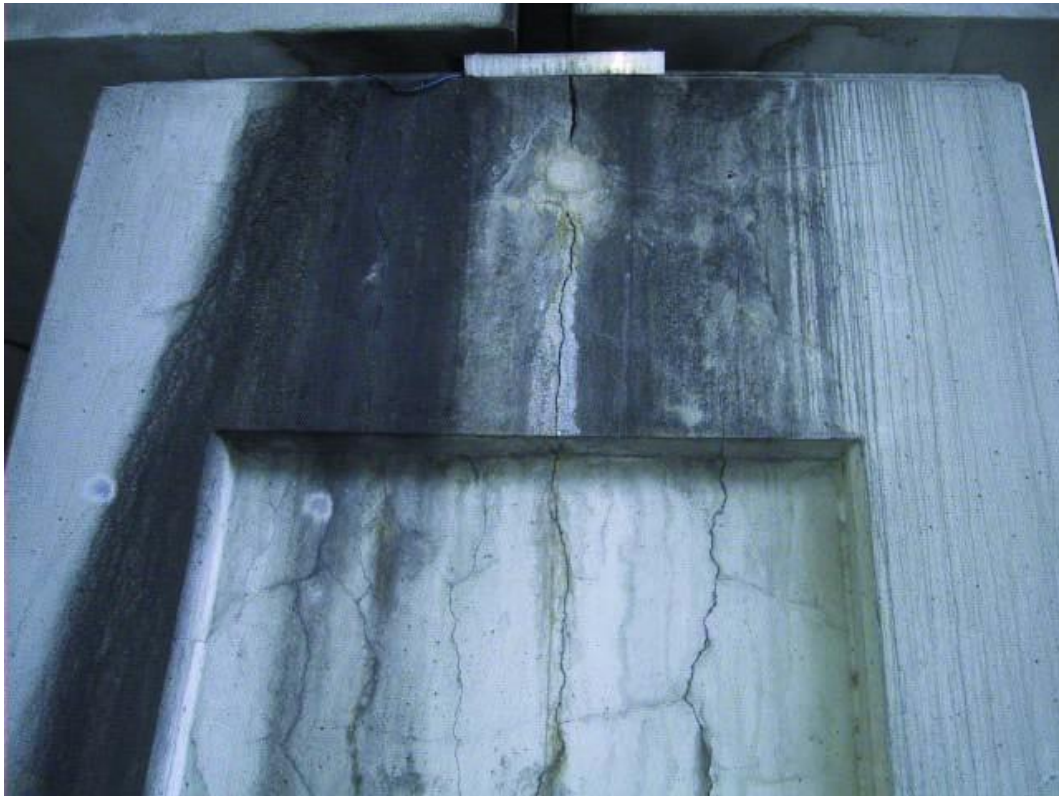
Figura 5: DEF en una columna en San Antonio, Texas [17]
