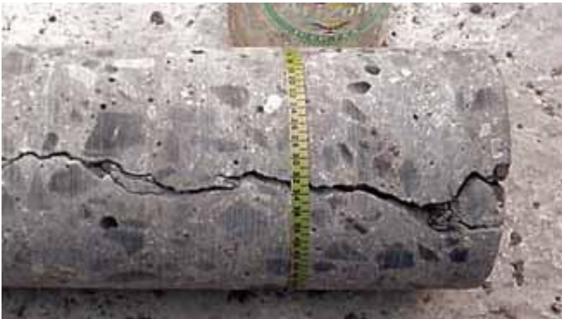
Figura 3: Una diamantina de concreto extraído de la base de una cimentación muestra el grado de fisuración térmica. [15]
