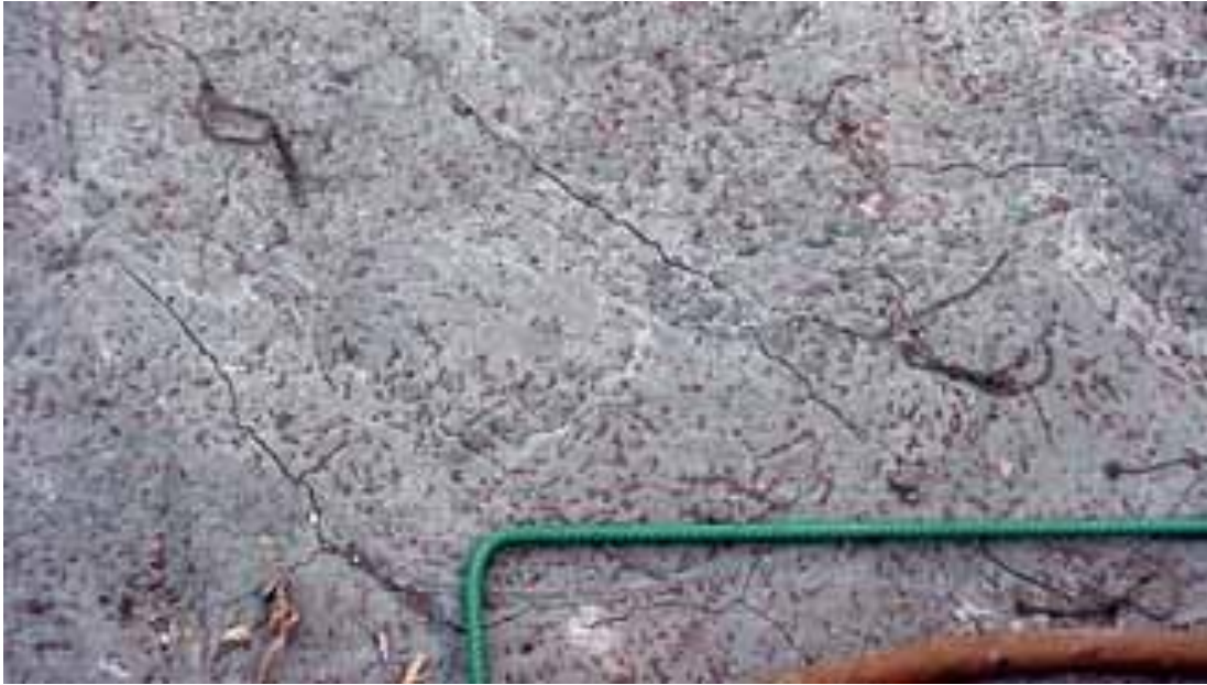
Figura 2: Ejemplo de agrietamiento térmico severo en la superficie superior de una cimentación [15]
