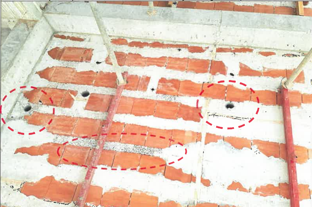
IMAG. N°10.- La Norma Técnica de Salud N°110-MINSA/DGIEM-V.01, señala que ningún elemento estructural permitirá la inserción de instalaciones de agua, desagüe, electricidad, mecánica y/o comunicaciones. Los ejecutores y la supervisión deberán definir el considerar a las viguetas como elementos estructurales y la pertinencia de su ubicación.
