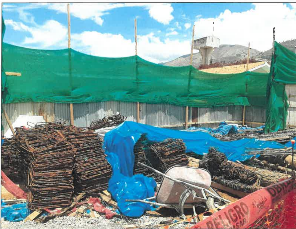
IMAG. N°09.- Se aprecia exposición de estribos de acero a la humedad y el aire originando un proceso de corrosión.
