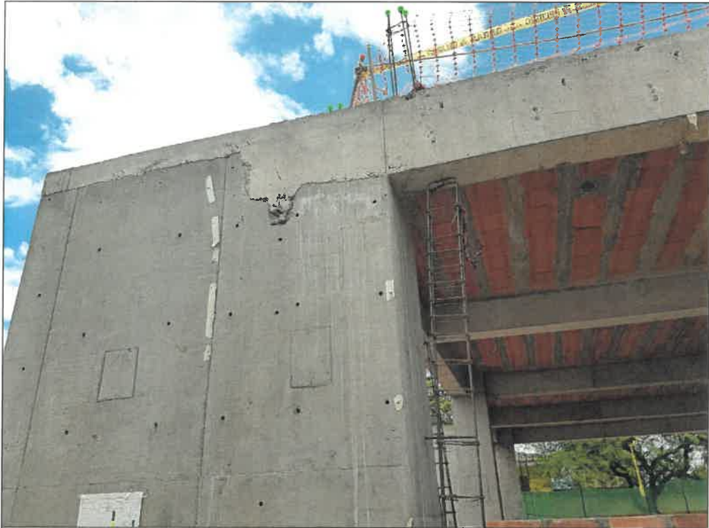
IMAG. N°11.- Se evidencia un contraste marcado del concreto debido al vaciado del mismo en 2 etapas. (1. columnas y/o placas 2. Vigas)
