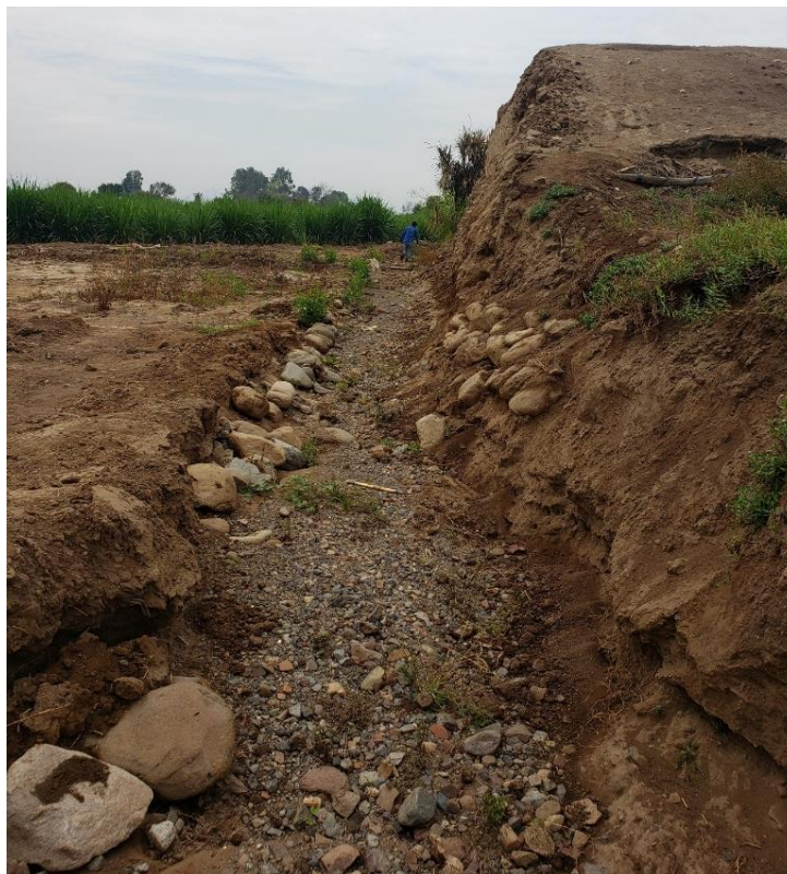
Imagen 08. Vista de Este a Oeste, del canal de regadío construido durante la remoción, excavación y nivelación del área conformante del sitio arqueológico "Huaca Tomabal". Nótese el corte de la proyección del montículo arqueológico.
