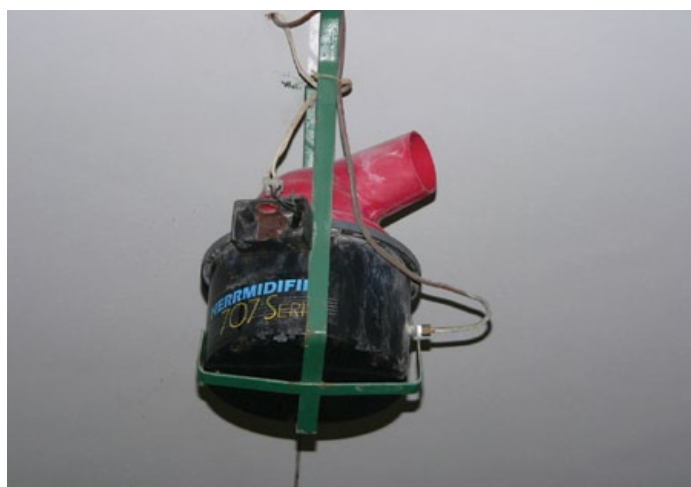
Unidad de humificación en cuarto de almacenamiento
