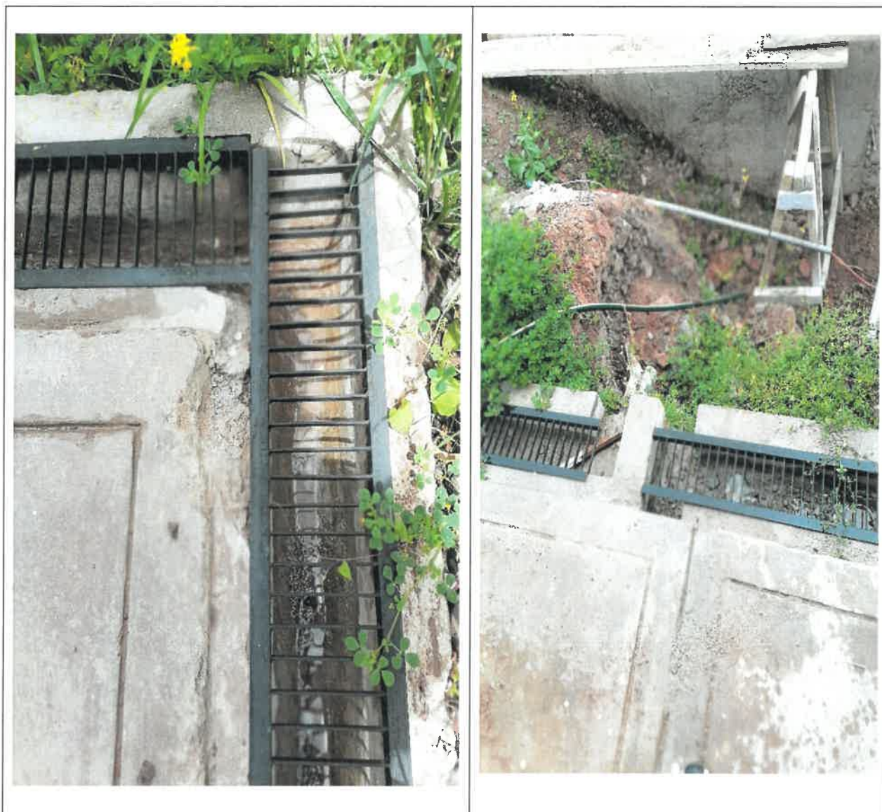
CANALETAS DE DESFOGUE CARENTES DE ACABADOS Y SIN COLECTORES A UNA POZA PERCOLADOR O HA UN LUGAR QUE NO CAUSE LA EROSIÓN DEL SUELO
