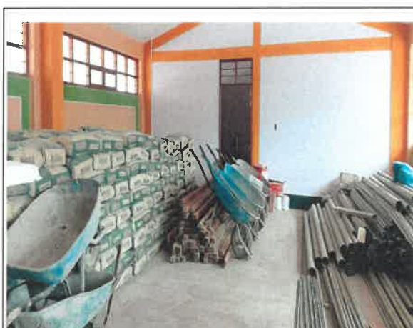
BIENES DEL ALMACEN NO CUENTA CON TARJETA DE CONTROL VISIBLE
