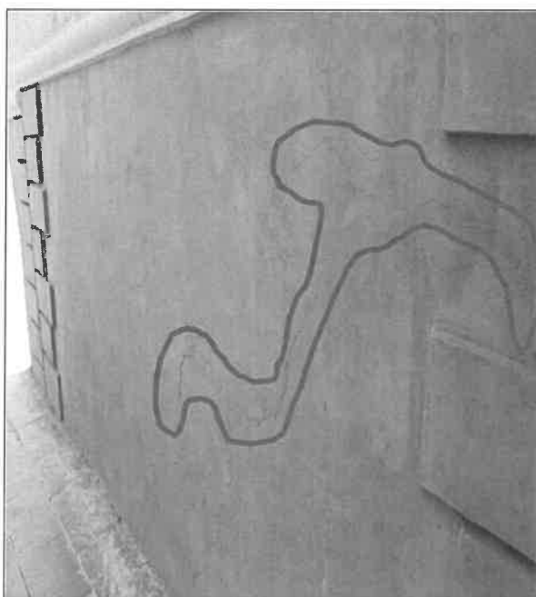
IMAG. N°11.- En el zócalo lateral, se aprecia fisuras en el tarrajeo.
