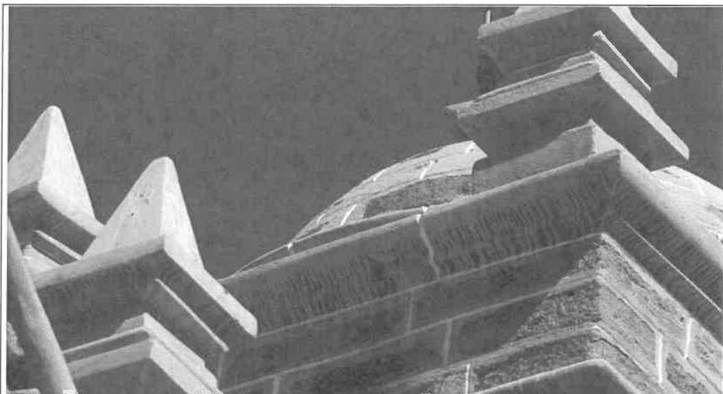
IMAG. N°02.- Se observan chorreras por la aplicación de cemento en los trabajos de restauración. Esto es muestra de una intervención de mano de obra no calificado en restauración. 7 La utilización del cemento en mayor porcentaje con respecto a la cal y arena deteriora el material lítico.
