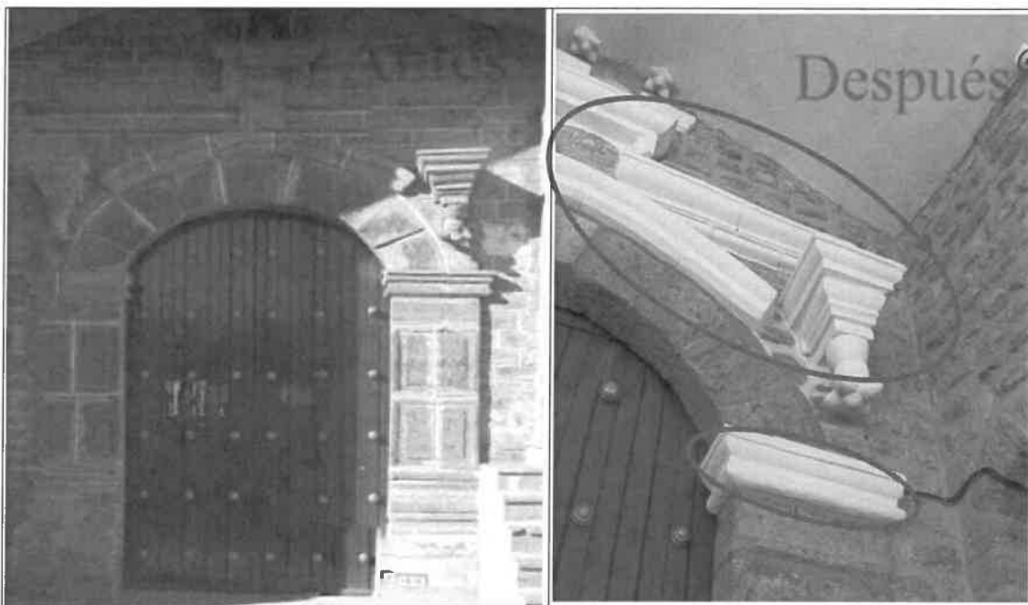
IMAG. N° 13.- Se ha intervenido el enlucido con acabado de color blanco en las cornisas. No se demuestra en el expediente técnico, que la fachada originaria sea de ese color, por lo que se estaría incurriendo en una falsa restauración.
