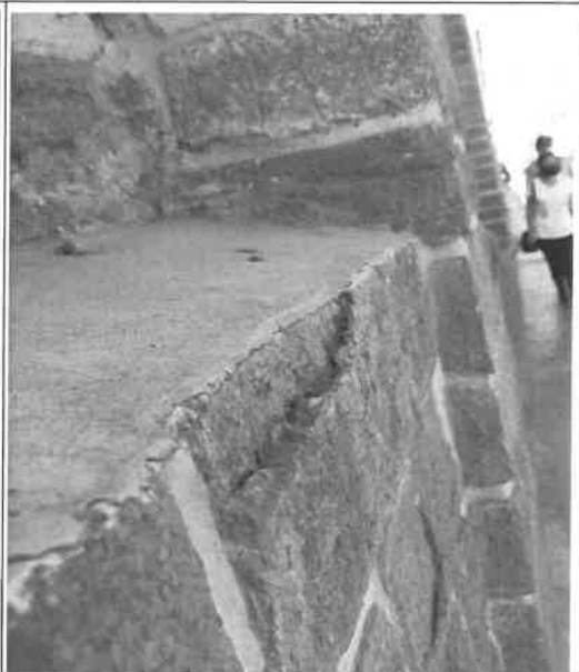
IMAG. N°07.- Zonas puntuales, donde no hubo una intervención adecuada de consolidación.
