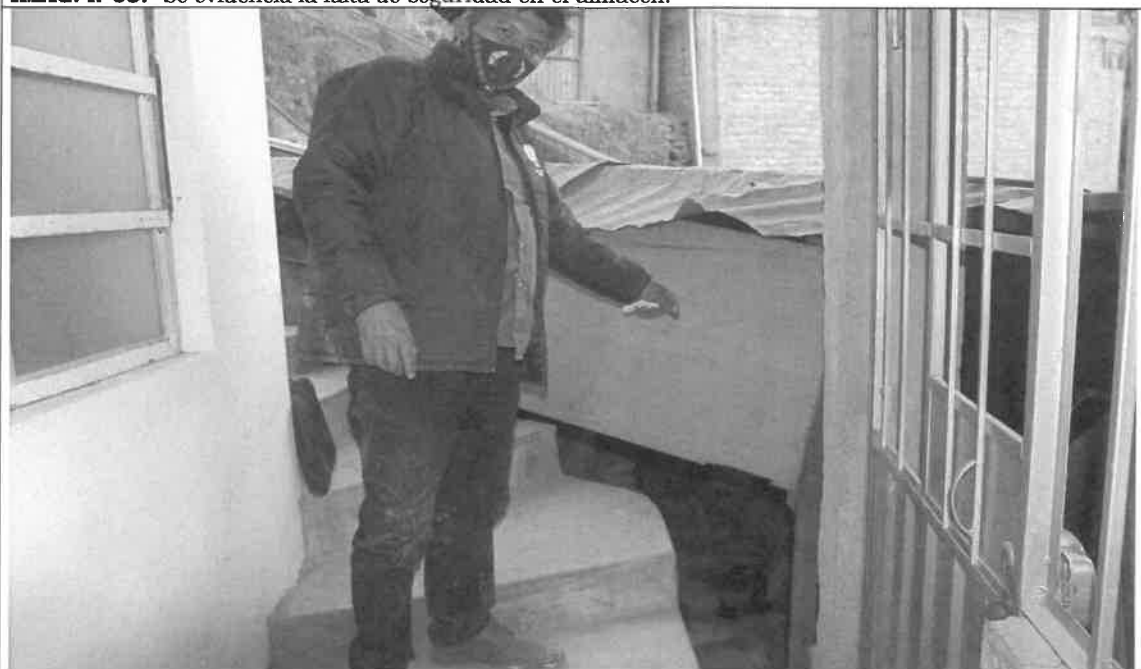
IMAG. N°06.- El techo del almacén es de calamina y triplay, asimismo cuenta con aberturas, lo cual evidencia la falta de seguridad.
