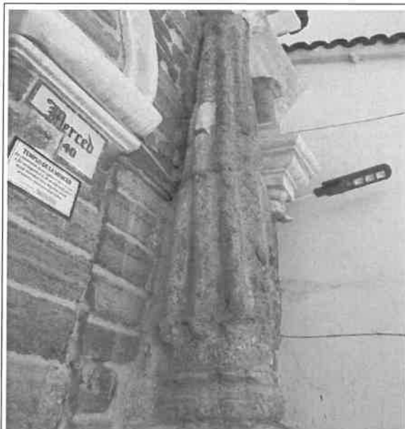
IMAG. N°09.- No se concluyeron con los trabajos de restauración, en la fachada frontal, principalmente en las columnas.
