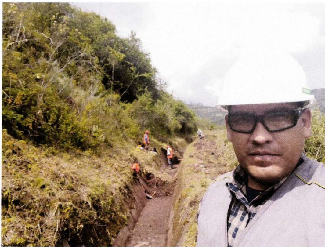
FOTO 14: VERIFICANDO TRABAJOS DE LIMPIEZA EN EL CANAL TRAMO 9+300KM
