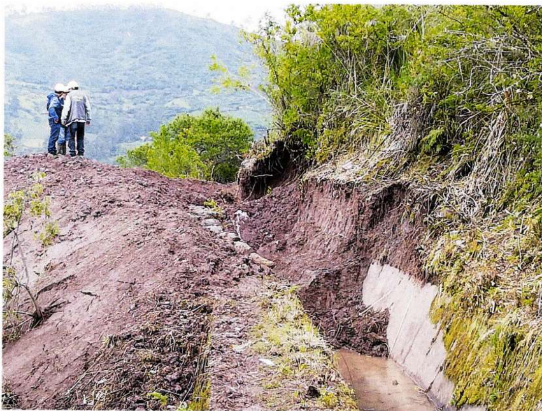
FOTO 07: SUPERVISION DE DESLIZAMIENTO EN CANAL DEBIDO A LA SATURACION DE AGUA EN EL TALUD EN LA PROGRESIVA 9+750KM
