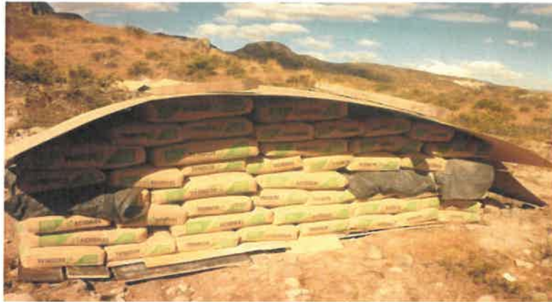
Inadecuado almacenamiento de cemento
