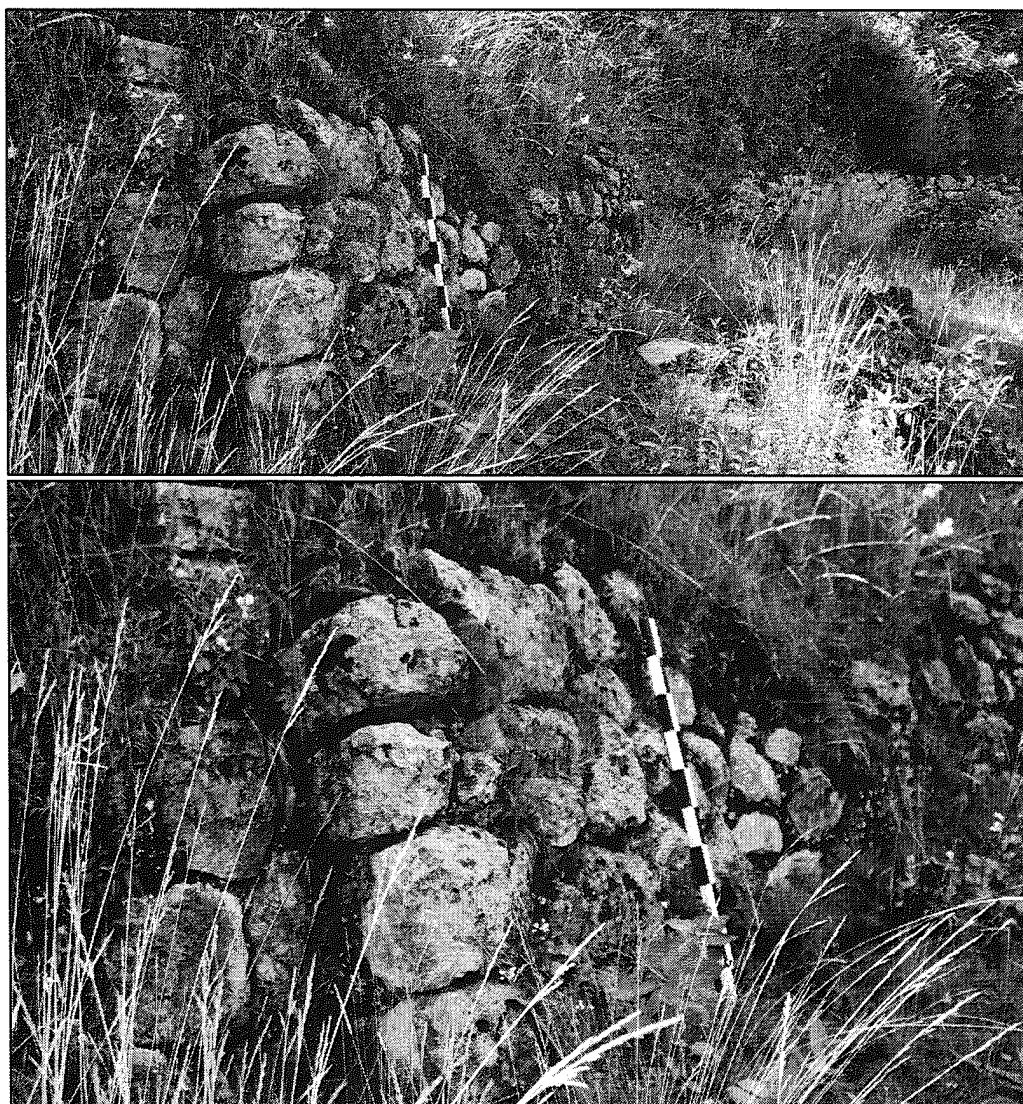
Registro fotográfico 7,8. Estado actual de los muros de contención de arquitectura prehispánica de 1,20m de altura cubierta de crecimiento de vegetación los cuales se encuentran en mal estado de conservación.
