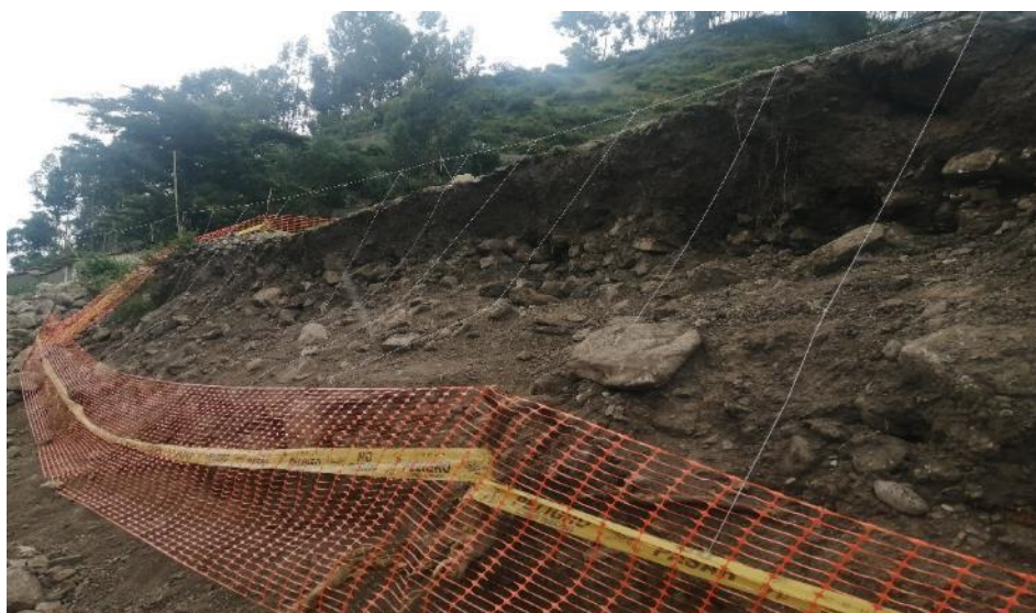
Fig. 13. Vista panorámica donde se observa que en el lugar se ha clorado una malla de protección y una cinta de peligro por obras, por parte de la empresa que ejecuta las obras en el lugar supervisado (Foto Sur a Norte).
