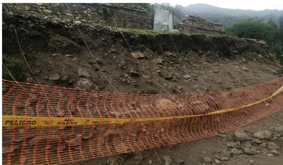
Fig. 9. Vista panorámica donde se observa que en el lugar se ha clorado una malla de protección y una cinta de peligro por obras, por parte de la empresa que ejecuta las obras en el lugar supervisado (Foto Norte a Sur).
