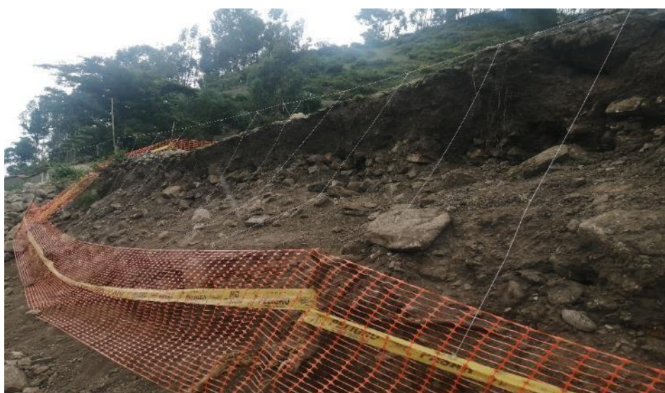
Fig. 10. Vista panorámica donde se observa que en el lugar se ha clorado una malla de protección y una cinta de peligro por obras, por parte de la empresa que ejecuta las obras en el lugar supervisado (Foto Sur a Norte).
