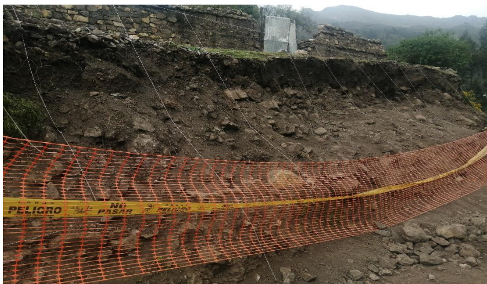
Fig. 12. Vista panorámica donde se observa que en el lugar se ha clorado una malla de protección y una cinta de peligro por obras, por parte de la empresa que ejecuta las obras en el lugar supervisado (Foto Norte a Sur).
