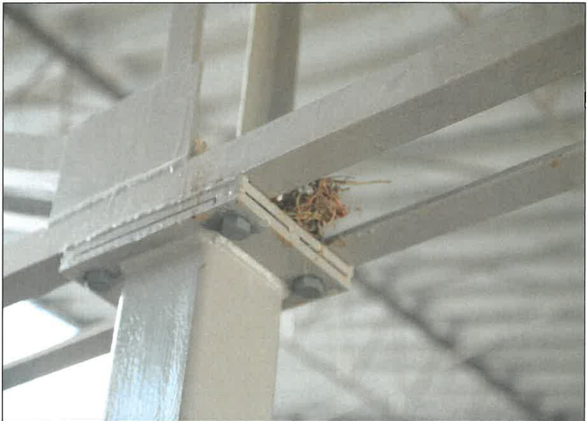
Evidencia nido de aves en las estructuras
