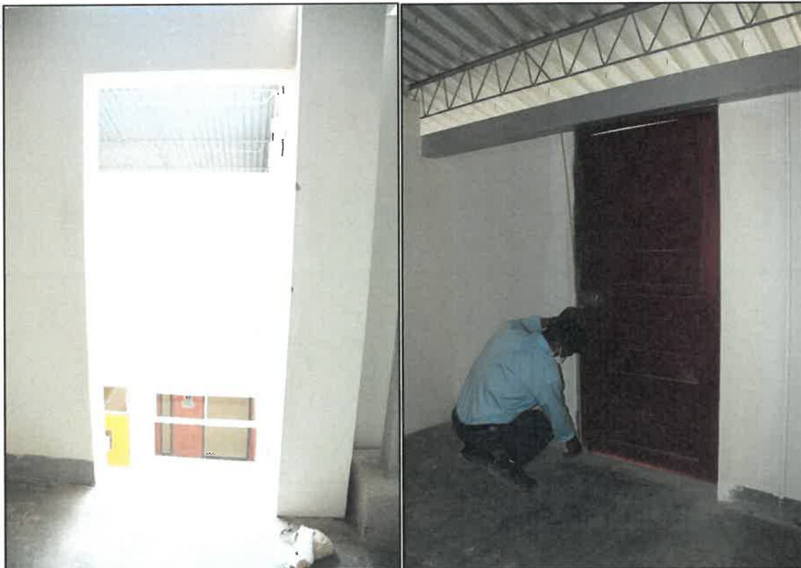
Espacio sin protección lateral de seguridad – puerta de ingreso principal de a=1\text{m} x h=2\text{m}
