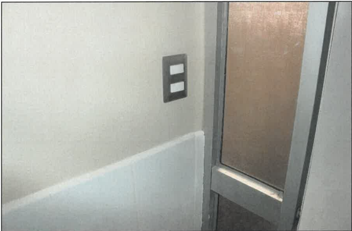
Interruptor ubicado dentro del servicio individual
