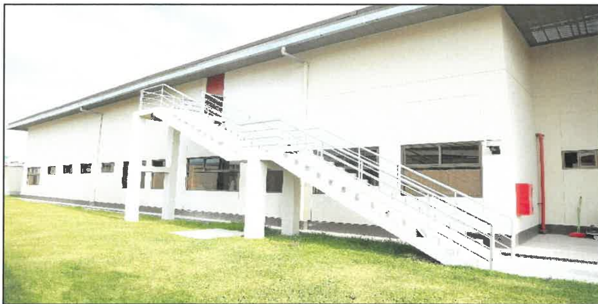
La escalera de acceso no cumple con la normativa técnica de salud en dimensiones
