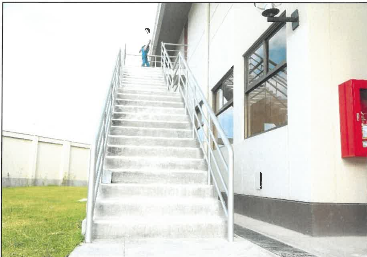
La escalera de acceso no cumple con la normativa técnica de salud en dimensiones
