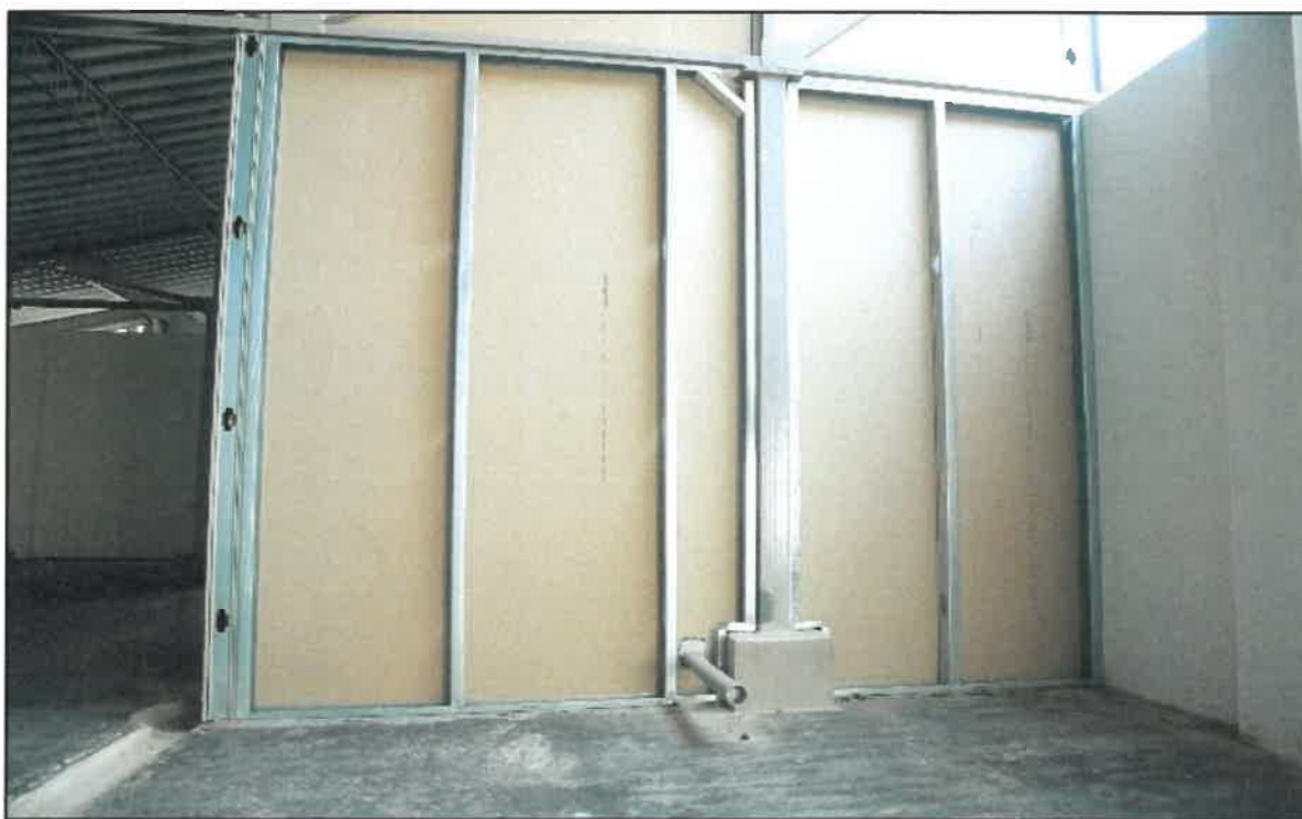
Se evidencia el módulo incompleto
