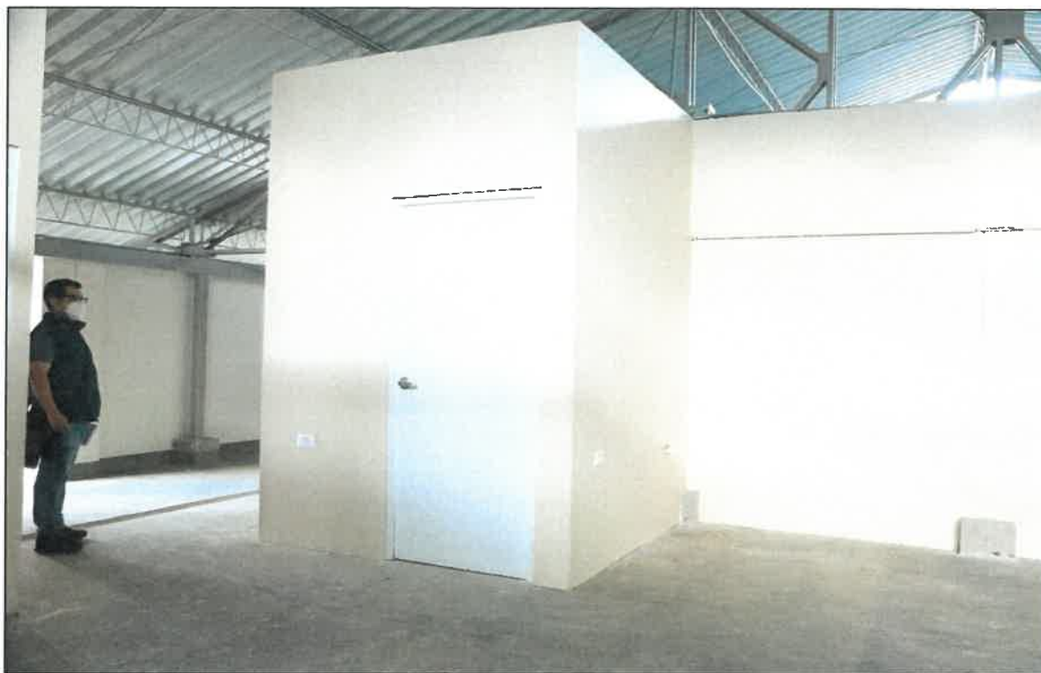
Ambientes inconclusos e inoperativos
