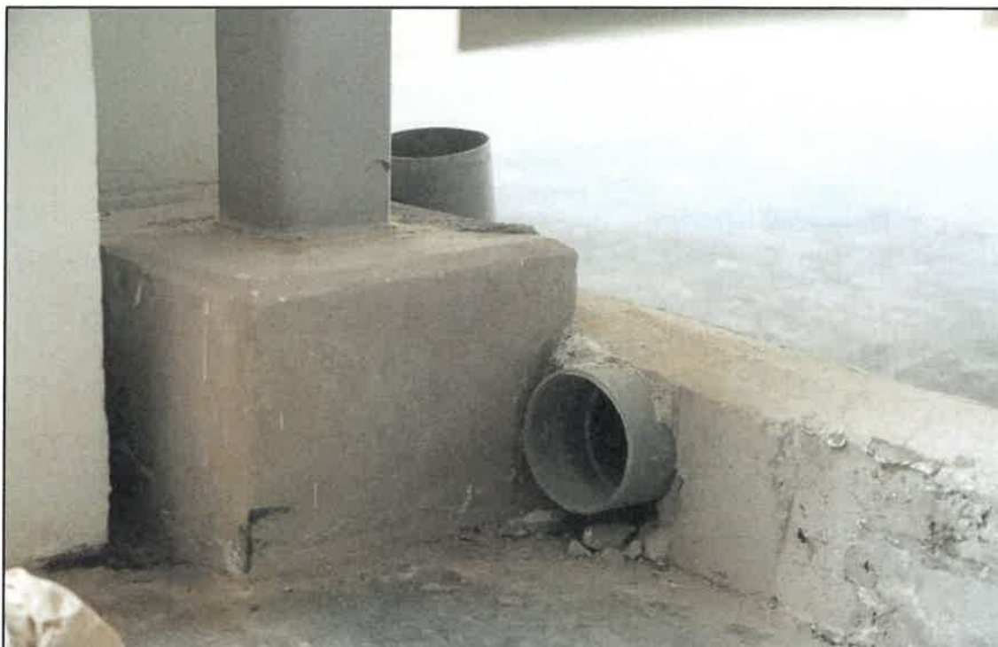
Terminales de la red de agua y desagüe no están conectadas a la red del hospital
