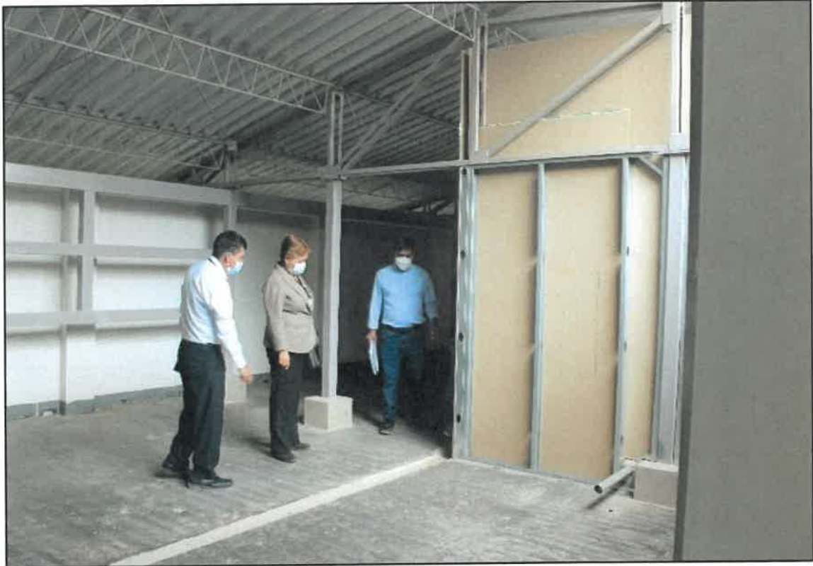
Terminales de la red de agua y desagüe no están conectadas a la red del hospital
