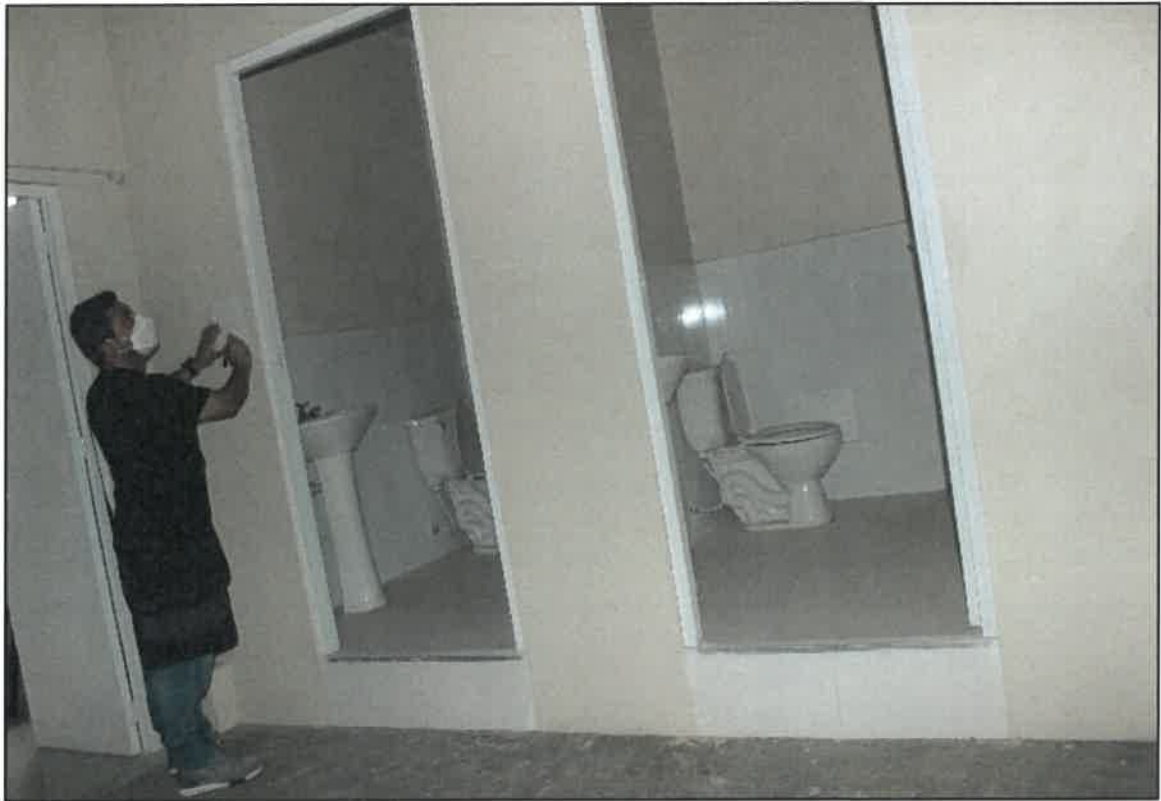
SS. HH: generales sin ventilación
