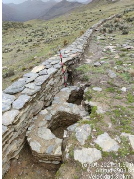
Foto N° 13.- Fotografía a detalle de la estructura arquitectónica del sitio arqueológico de Curipunta, donde se observa la intervención, evidenciada por el mortero de barro fresco, el cual se diferencia de lo prehispánico. Asimismo, se observa la exposición de estructuras que se encontraban subyacentes al suelo.
