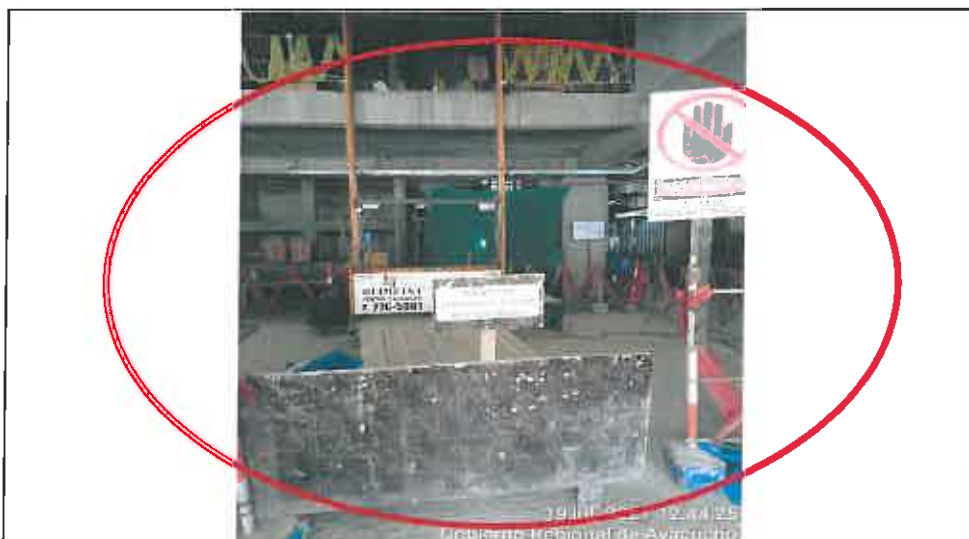
No se evidencias letreros de advertencia, obligación y prohibición.
