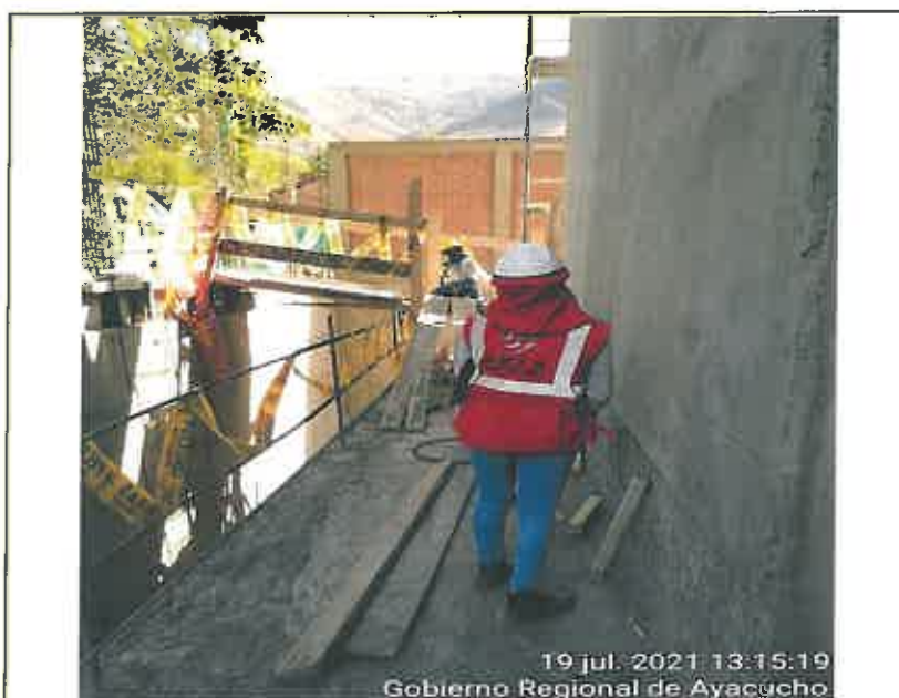
Personal laborando sin anclaje respectivo.
