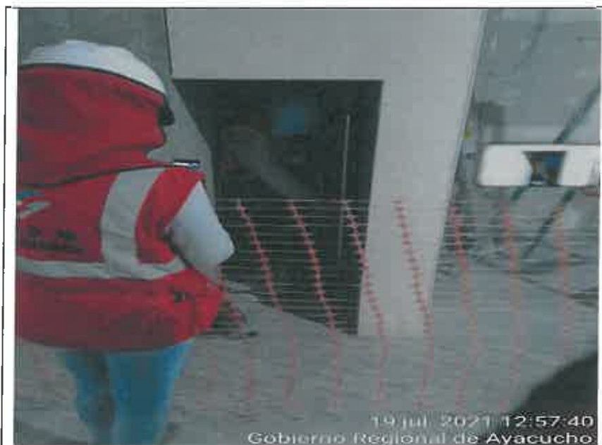
Personal trabajando sin la luminaria respectiva en la zona de trabajo.
