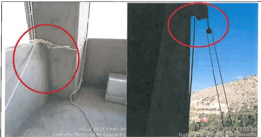
Cuerdas desgastadas y empalmadas, que viene siendo utilizado en el izaje de materiales.
