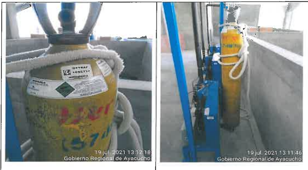
Se observa balón de nitrógeno junto a equipos eléctricos y sujetados con cuerdas.
