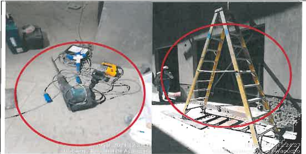
Equipos de poder y escaleras si las cintas de inspección de trabajo.
