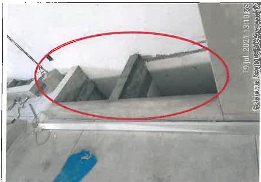
Zona de ductos sin las guardas respectivas – espacios vacíos- Nivel 6
