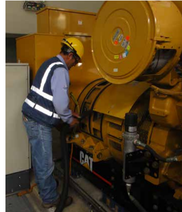
Mantenimiento de LT y SES
