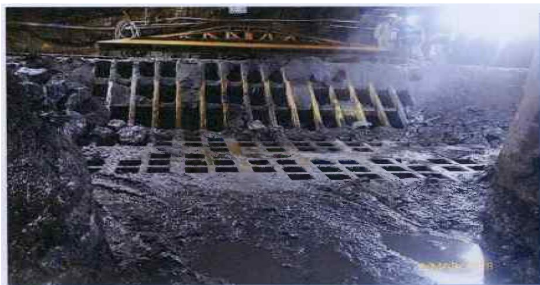
FOTO N° 66: Vista del Pocket (echadero) N° 2 de mineral, ubicados en el CX 2376, del Nv 1070 del pique Mascota (mina Central); no cuentan con muro de seguridad, como establece el RSSO, asimismo, el scooptram diésel EIMCO Jarvis Clark EJC 130 de 3.5 yd 3 es de 1.24 m y la altura equivalente a los 2/3 de la llanta es de 0.826 m
