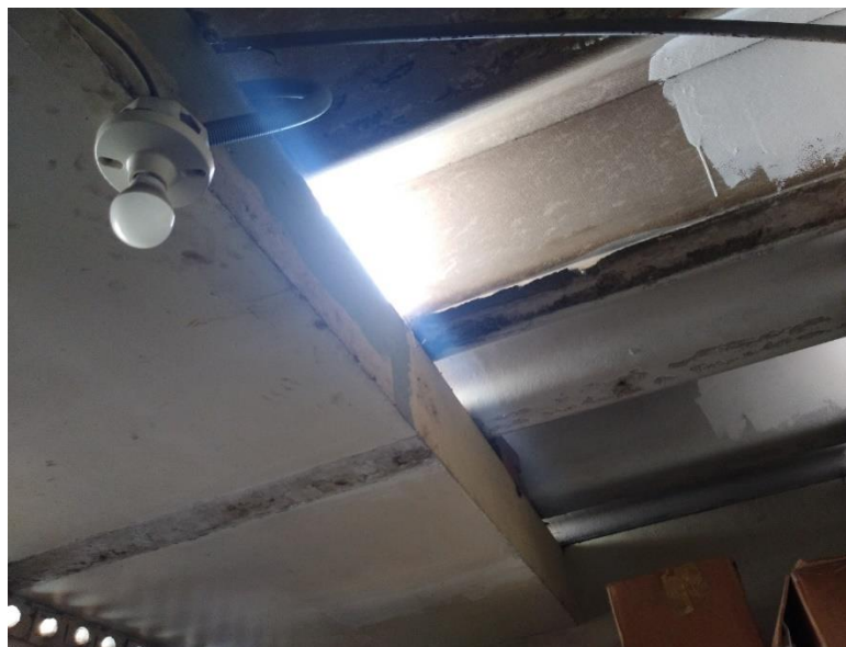
Foto 5. Condición del techo del Almacén del Laboratorio de cocinas mejoradas
