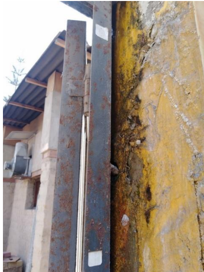
Foto 7. Condición de la puerta de los ambientes de ensayo
