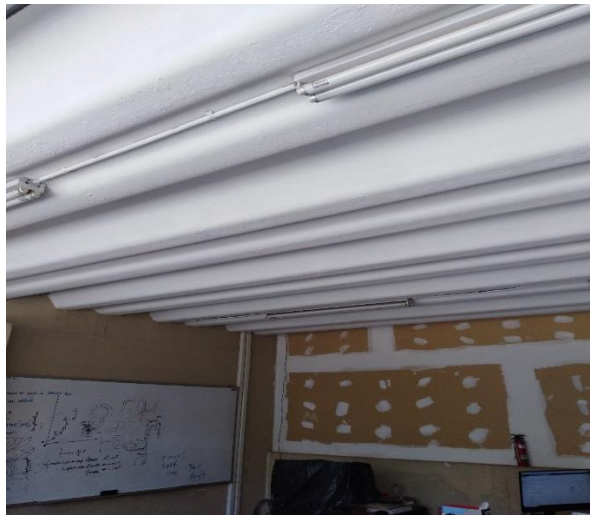
Foto 1. Condición del techo del Laboratorio de Evaluación de cocinas mejoradas
