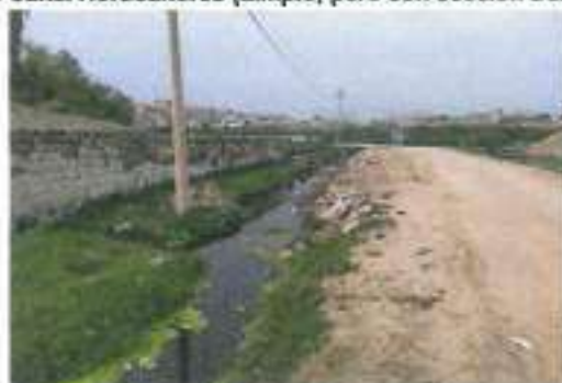
Imagen N° 22: Canal Horticultores (Limpio; pero con sección transversal deformada).
