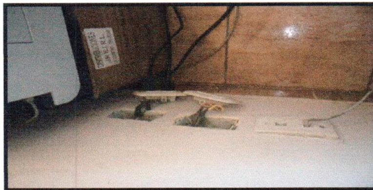
Tomacorrientes en muy malas condiciones
