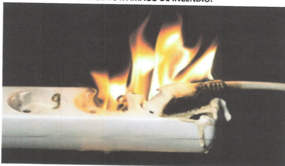
IMAGEN 04: AMAGO DE INCENDIO.
