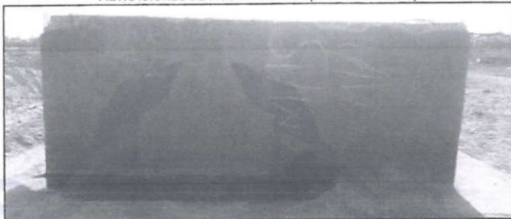
IMAGEN N° 4 FILTRACIONES DE AGUA EN MURO (PARTE INFERIOR)
