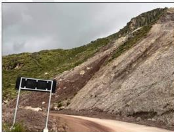
Reptación de suelo en el centro poblado de Huaylacucho - Huancavelica
