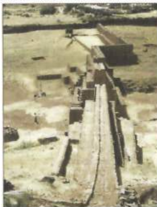
Registro Fotográfico N° 42: PORTADA RUMIOLQA VULNERABLE A LA CAÍDA DE ROCAS
