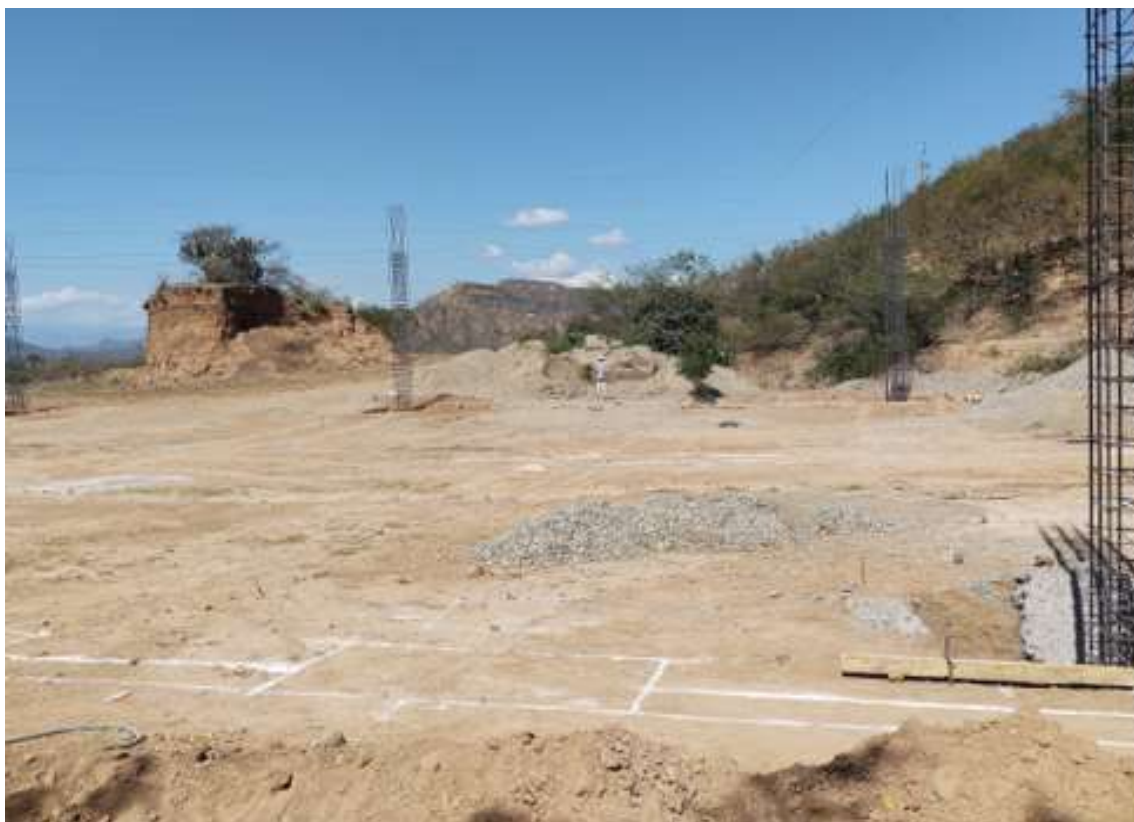
Foto N° 09.- Panorámica del montículo menor y montículo mayor sitio Arqueológico Huaca Mayor, afectados por trabajo de creación de Infraestructura.
