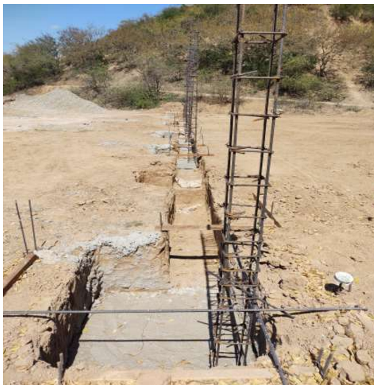
Foto N° 10.- Vista en detalle de las construcciones de columnas y zapatas en el área Intangible del sitio Arqueológico Huaca Mayor, afectados por trabajo de creación de Infraestructura.
