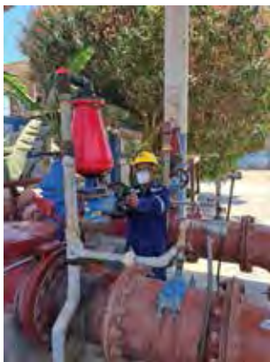
Ilustración 34: VPA para aguas residuales en un pozo. Nótese que aguas abajo hay una válvula compuerta. Fuente: Imagen del autor.
