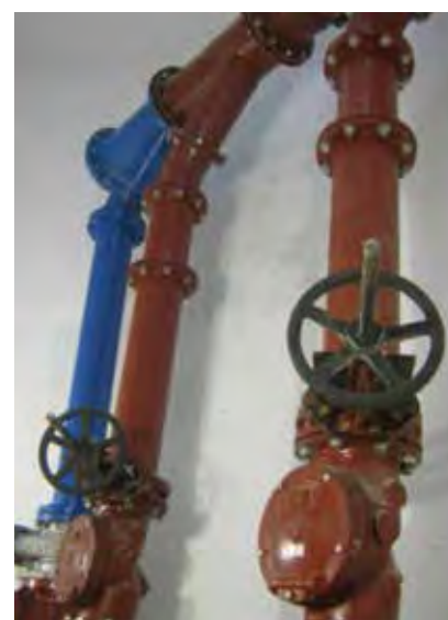
Ilustración 41: Árbol de la línea de impulsión de una EBAR. Se aprecian las válvulas compuerta y check. Fuente: Imagen del autor.
