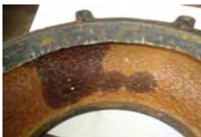
Ilustración 80: Al humedecer la carcasa se aprecian las perforaciones a dicho accesorio. Fuente: Imagen del autor.
