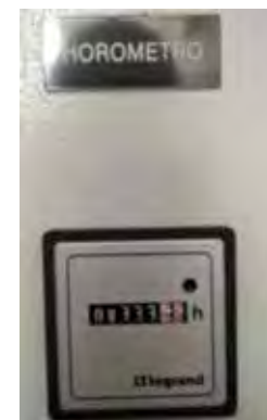
Ilustración 21: Horómetro de una bomba. Fuente: Imagen del autor.
