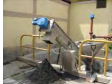
Ilustración 72: Otra vista del mismo equipo. Fuente: Imagen del autor.
