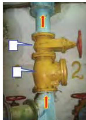
Ilustración 47: 1:Válvula check + 2: Compuerta en EBAR. Fuente: Imagen del autor.
