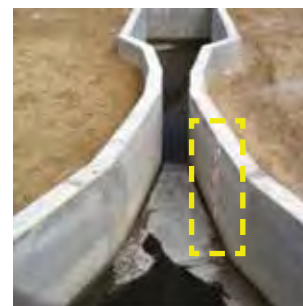
Ilustración 105: Canal Parshall del afluente del PTAR Tamarindo. Se señala el limnógrafo o regla. Fuente: Imagen del autor.
