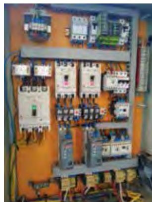
Ilustración 60: Vista del interior del tablero. Note la cantidad de interruptores. Fuente: Imagen del autor.
