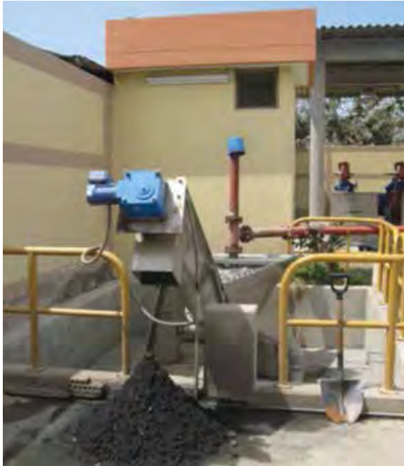
Ilustración 71: Vista de un equipo para separar los sólidos sedimentados en un desarenador de una EBAR, que emplea un "tornillo sin fin". Fuente: Imagen del autor.
