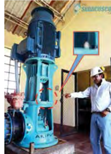
Ilustración 33: Similar control de calidad para las vibraciones en un nuevo equipo de bombeo de gran caudal. Persona de la imagen señala la moneda puesta de canto que no cae por las vibraciones generadas por el equipo. Fuente: Imagen Facebook SEDACUSCO.
