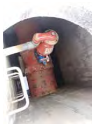
Ilustración 35: VPA para aguas residuales dentro de su caja. Se aprecia el tubo que devuelve el exceso de aguas residuales. Fuente: Imagen del autor.
