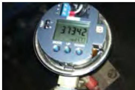
Ilustración 111: Sensor de presión con display en línea de impulsión. Fuente: Imagen del autor.
