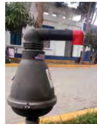
Ilustración 36: VPA para aguas residuales. Nótese la diferencia de forma al compararla con la usada en el pozo. Fuente: Imagen del autor.
