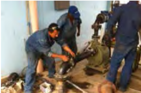
Ilustración 86: Personal técnico revisando el equipo de bombeo de una EBAR de una localidad de Perú. Fuente: Imagen del autor.
