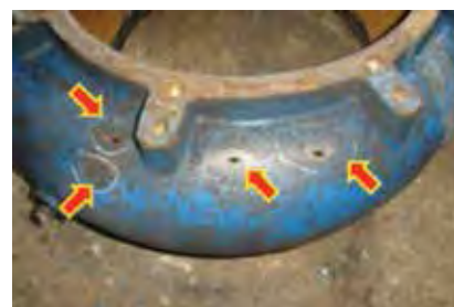
Ilustración 78: Se señalan las perforaciones de la carcasa.
