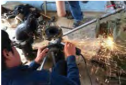
Ilustración 87: Fue necesario desarmar el árbol de impulsión de la EBAR para acceder al interior de la bomba. Fuente: Imagen del autor.
