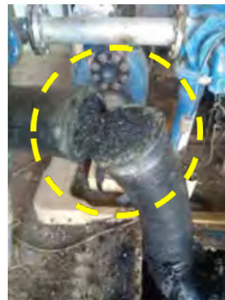
Ilustración 75: Al cortar la manguera de descarga de la bomba se encontró que estaba totalmente obstruida en toda su sección por sólidos.
