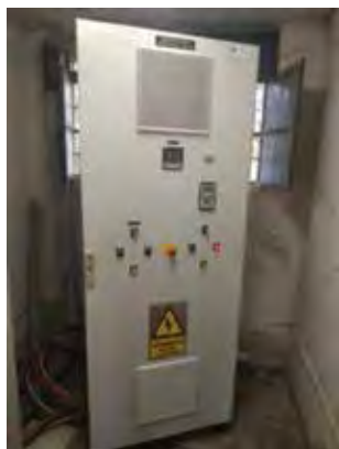
Ilustración 59: Vista del exterior de un tablero. Fuente: Imagen del autor.
