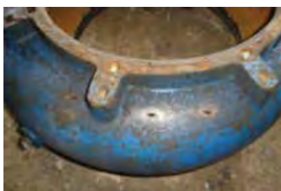
Ilustración 77: Acercamiento a la carcasa.
