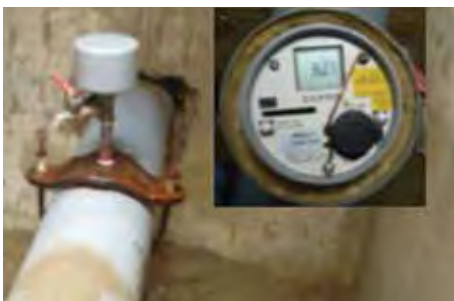
Ilustración 110: Equipo portátil logger de presión con display. Fuente: Imagen del autor.
