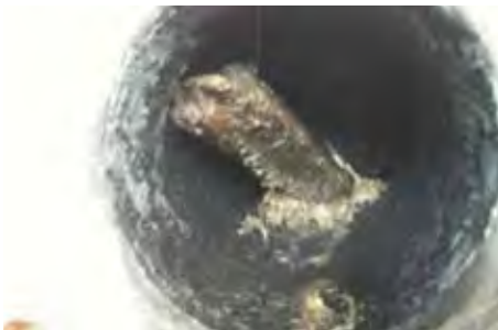
Ilustración 89: Se aprecia que un pedazo de madera está atorado en el interior. Fuente: Imagen del autor.
