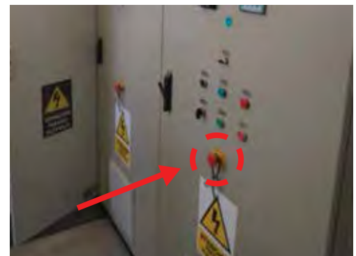
Ilustración 97: Tablero general de equipos electromecánicos de una EBAR típica. Se señala el pulsador de "Parada de Emergencia" tipo hongo. Fuente: Imagen del autor.
