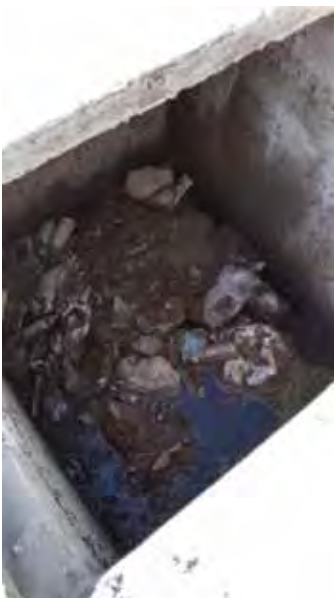
Ilustración 7: Vista de la cámara de rejas de una estación de bombeo de aguas residuales. Fuente: Imagen del autor.
