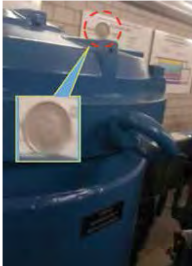
Ilustración 32: Control de calidad para las vibraciones en un equipo de bombeo de gran caudal en la PTAP Werkbetriebe Frauenfeld (Suiza). Una moneda puesta de canto no se cae a pesar de la operación (vibración) del equipo. Fuente: Imagen del autor.
