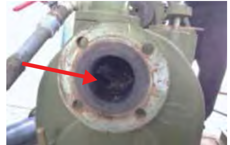
Ilustración 88: Se pudo observar que un sólido extraño se encontraba atascado en el impulsor de la bomba. Fuente: Imagen del autor.
