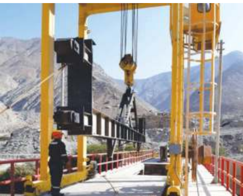
Mantenimiento mecanismo de izaje
