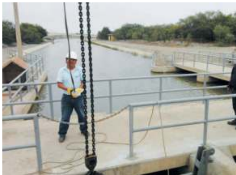
Regulación de compuertas y ataguías en la estructura de Control y Seguridad IHM
