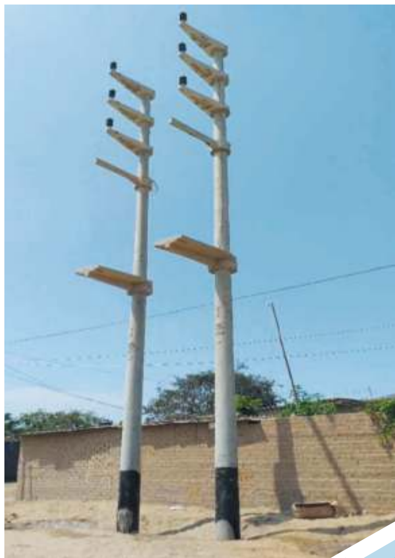
Instalación de bipostes con sus respectivas ménsulas de concreto armado y aisladores de losa
