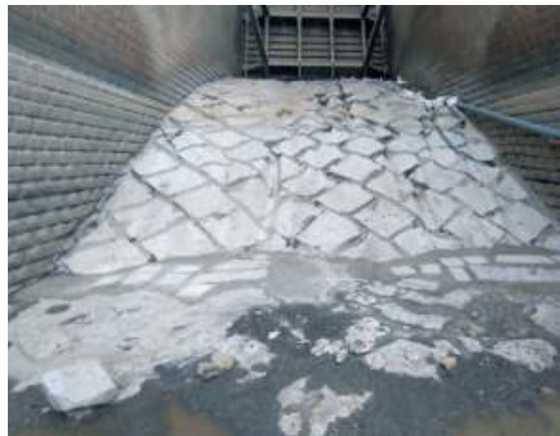
Enchapado de piedra labrada y aplicación de mortero de alta resistencia - Poza limpia 02
