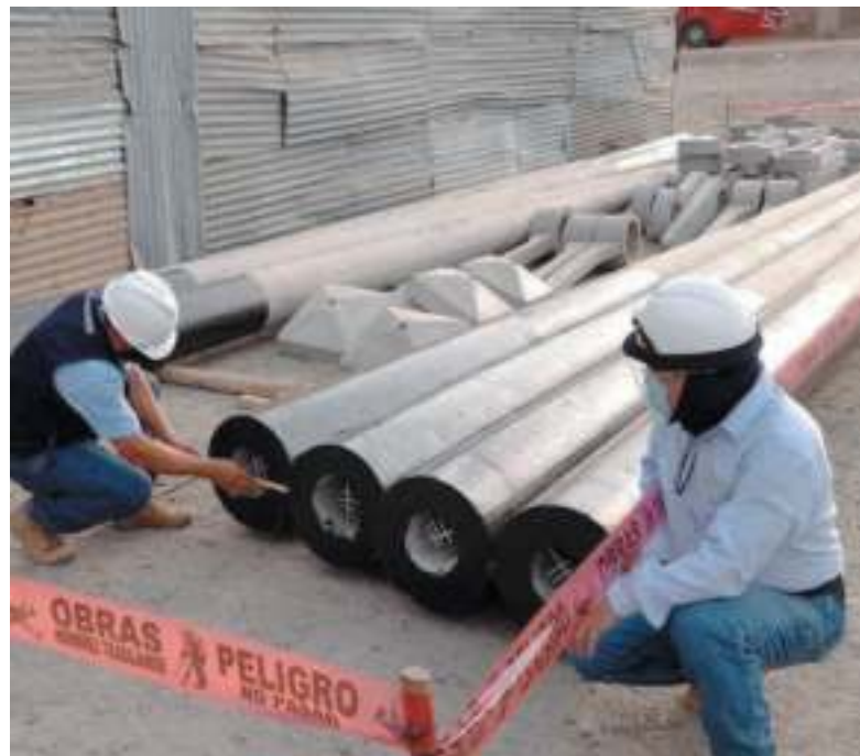
Revisión de suministro de postes de concreto armado centrifugado
