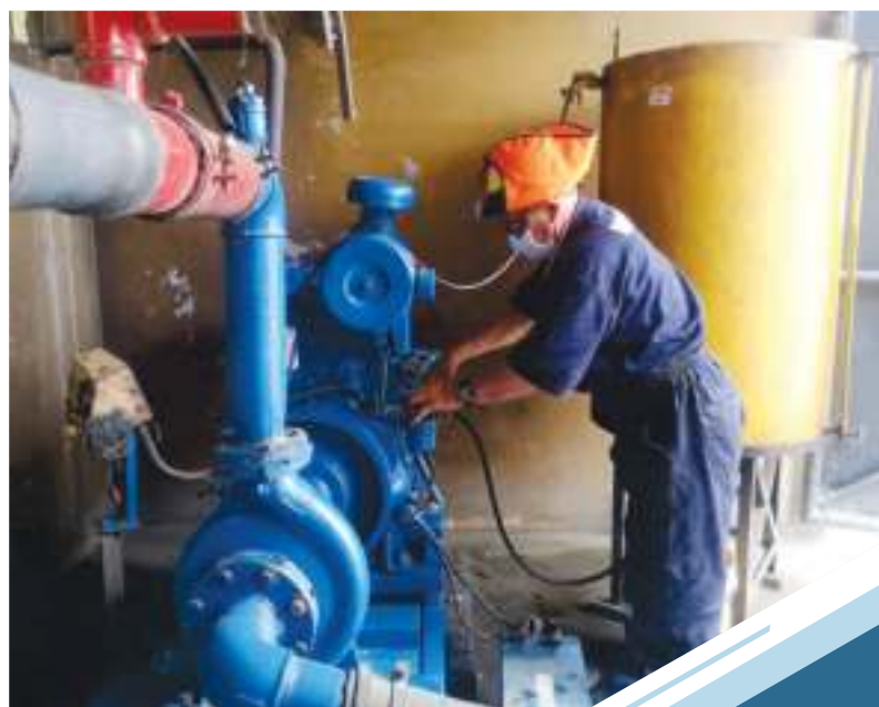
Mantenimiento de grupos electrógenos y motores
