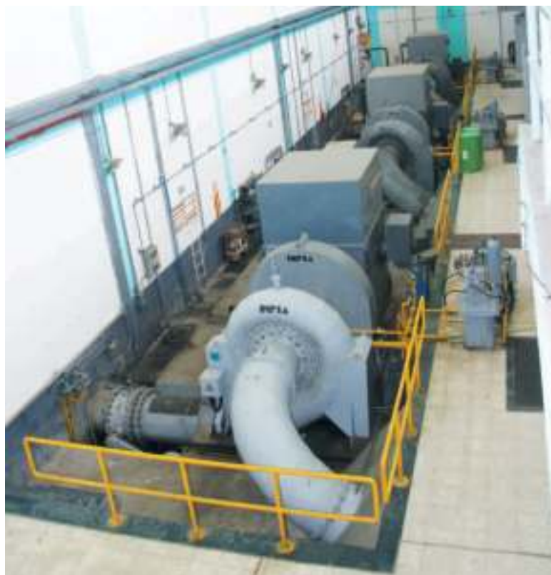
Turbinas de Mini Central Hidroeléctrica de Virú
