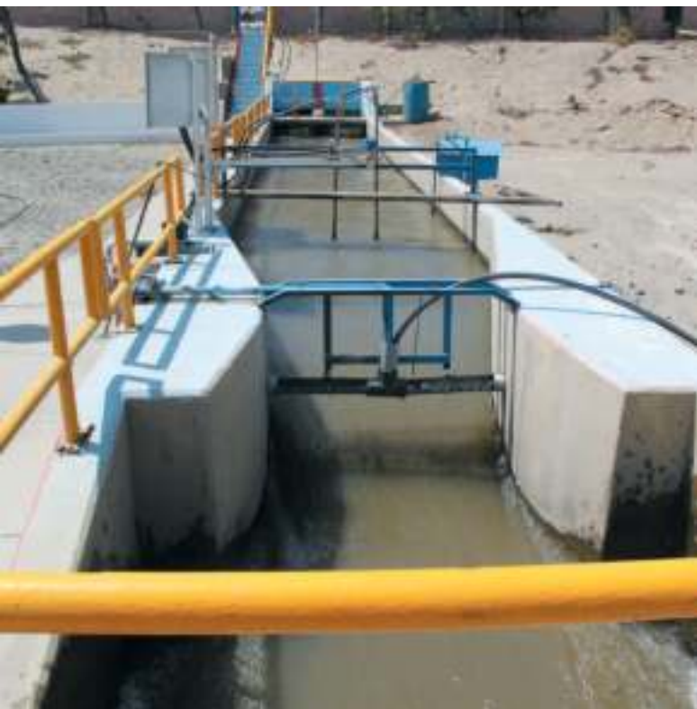
Canal aductor de la Planta de Tratamiento de Agua Potable
