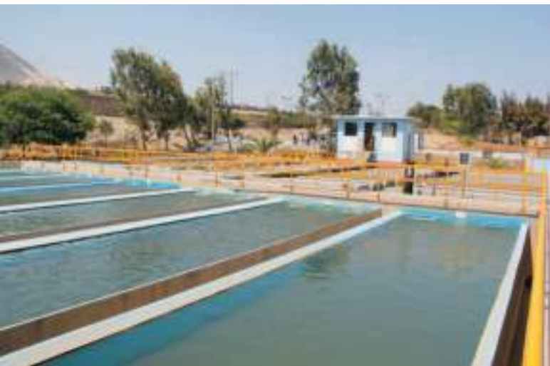
Batería de filtros de la Planta de Tratamiento de Agua Potable
