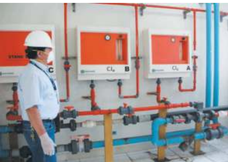
Sala de Clorinación de la PTAP
