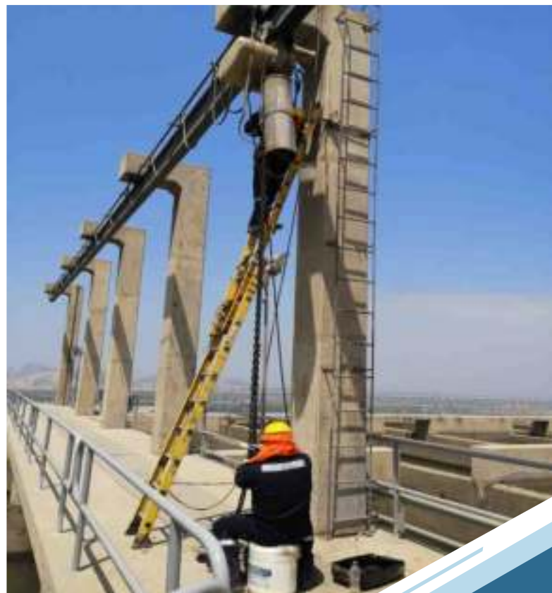
Mantenimiento mecanismo de izaje
