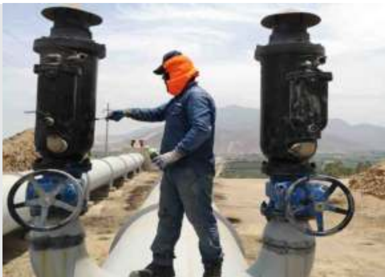
Mantenimiento de válvula de sifones Virú
