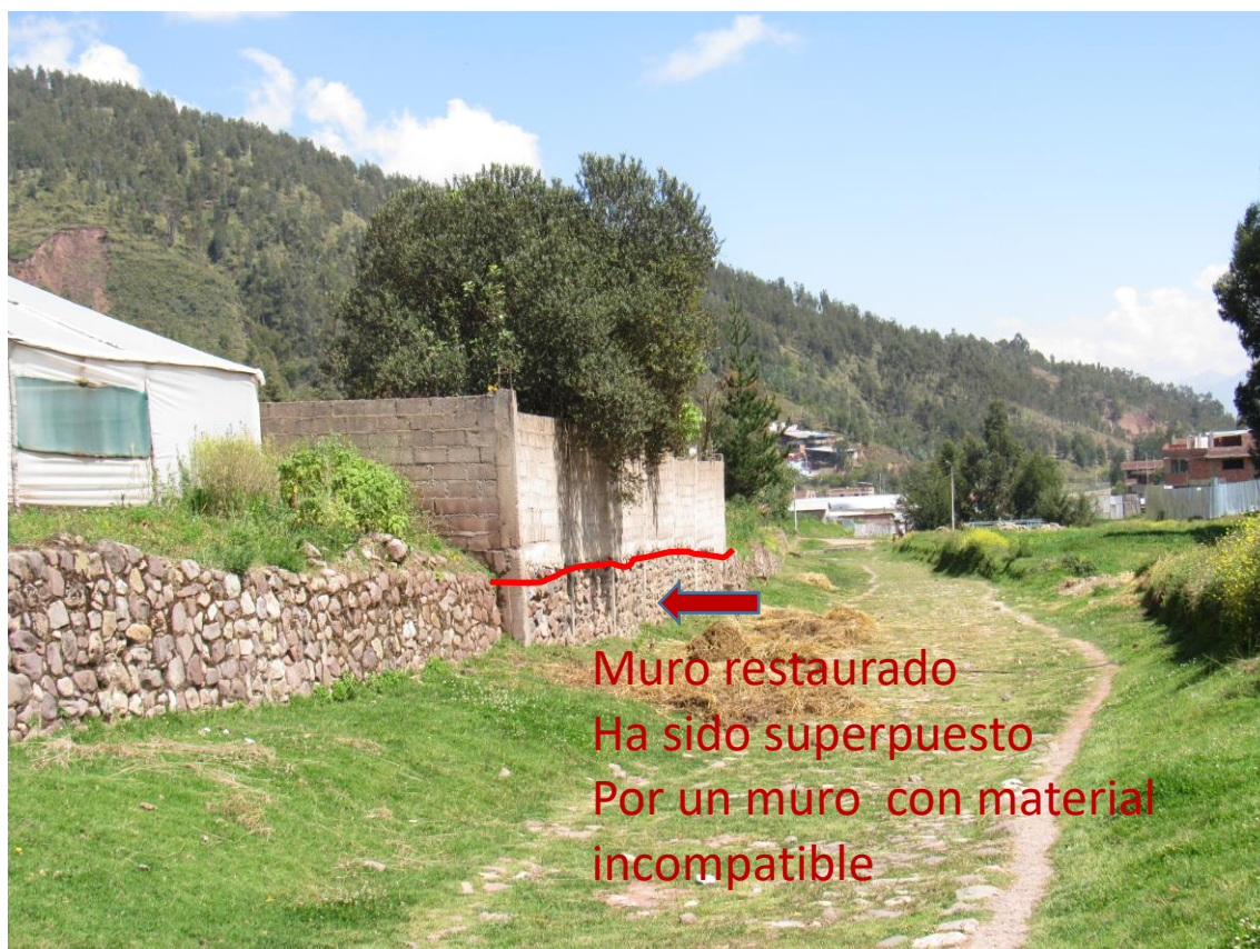
Vista del trazo del camino en el segmento 6, donde se aprecia la superposición de un muro contemporáneo con materiales incompatibles al muro restaurado.
