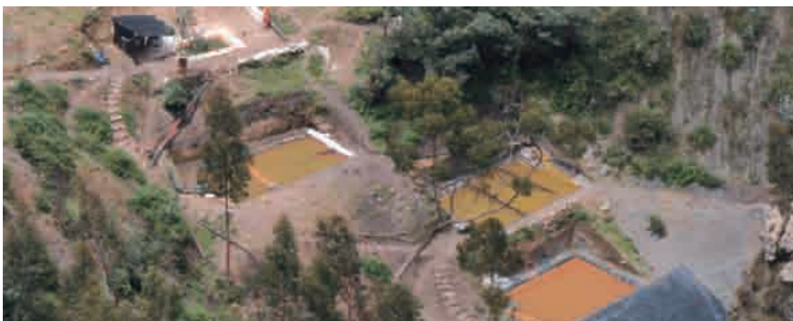
Planta Piloto de Neutralización de Aguas ácidas del Túnel Pucará, Pasco, Perú.
