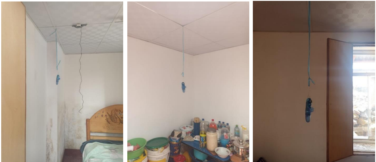
Fot. 09: Equipos instalados al interior del ambiente 1, ambiente 2 y ambiente 3 en la vivienda "B" (SUMAQ WASI de adobe)
