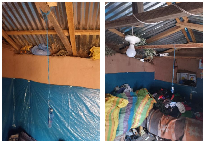
Fot. 14: Sensores instalados al interior de la vivienda "G" (vivienda tradicional de adobe)
