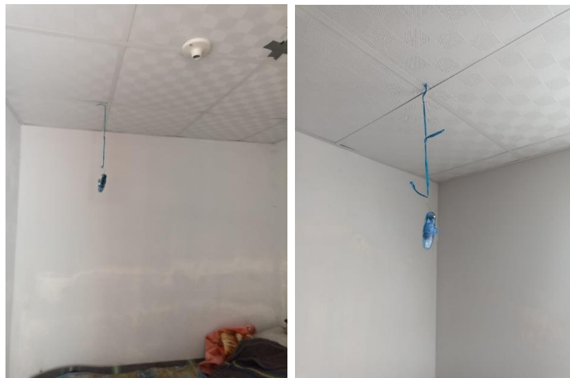
Fot. 13: Equipos instalados al interior del ambiente 1 y ambiente 2 en la vivienda “F” (SUMAQ WASI de ladrillo)
