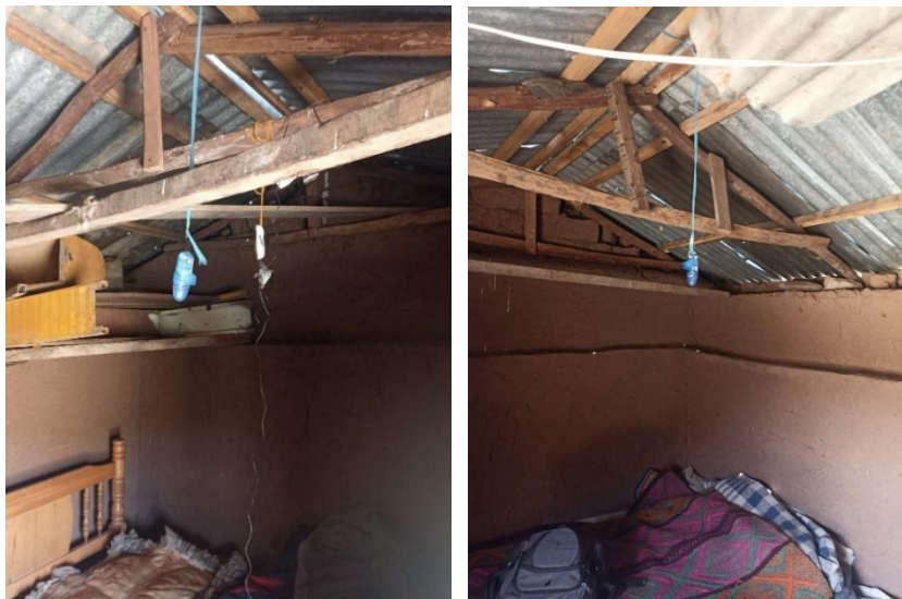
Fot. 11: Sensores instalados al interior de la vivienda “D” (vivienda tradicional de adobe)
