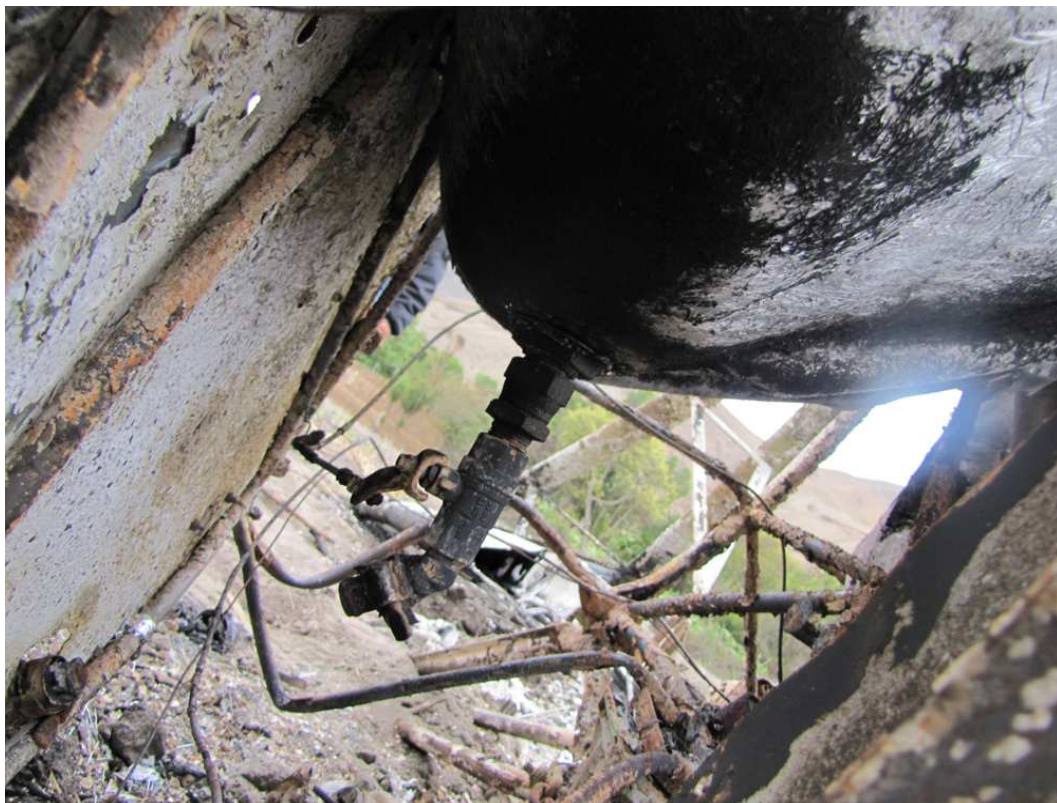
Parte inferior del tanque de combustible con válvula de corte Shutt-Off en posición "Cerrado".
