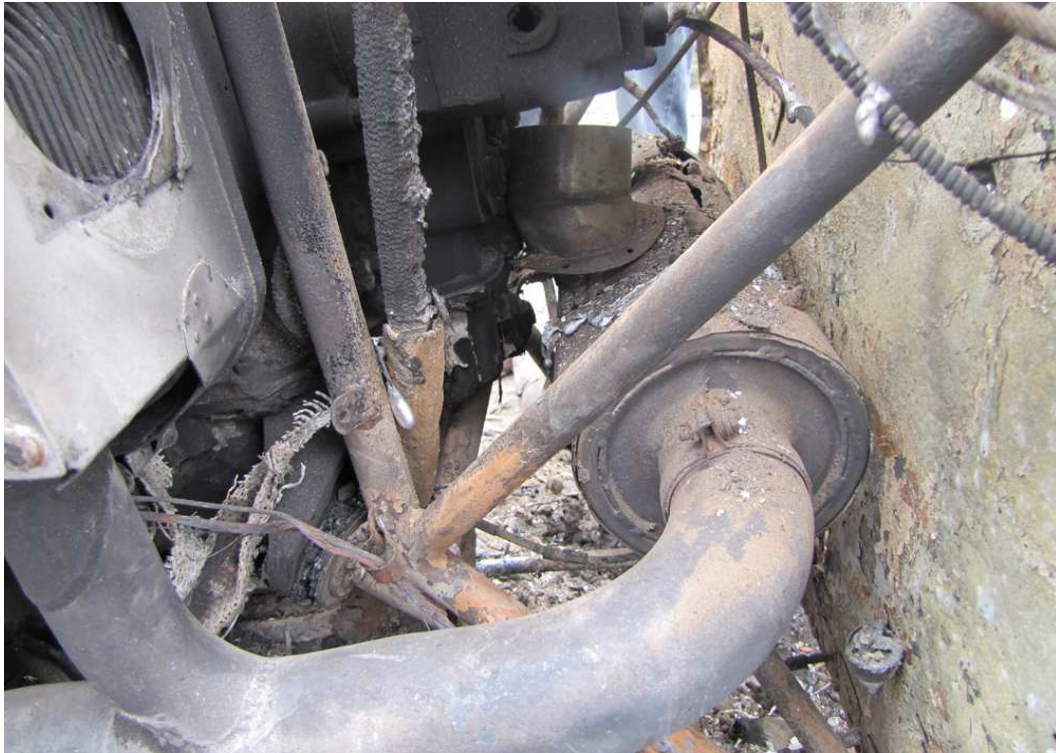
Vista de detalle del sistema de escape, obsérvese la conexión del tubo colector de gases del lado izquierdo a la toma del "silenciador".
