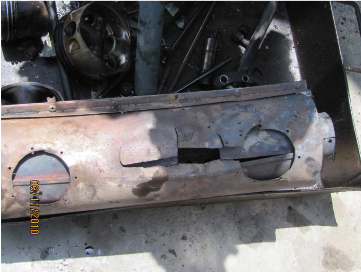
Tubo de escape parte superior, con decoloración y daños del tubo externo del lado derecho, obsérvese los daños del tubo intermedio con cortes lo que deja expuesto el "Silenciador".
