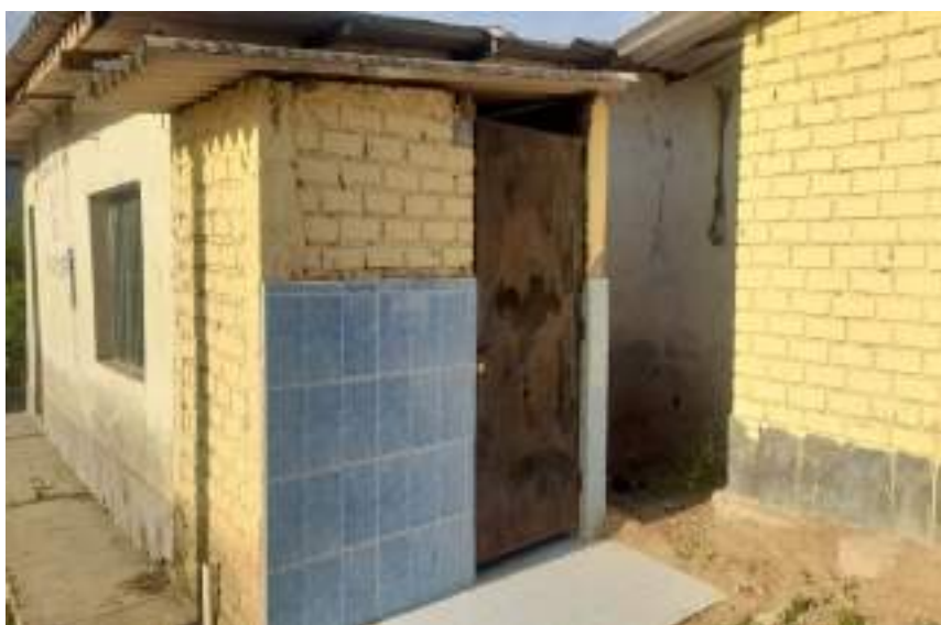
FOTO N° 05: Se muestra los ss.hh de material noble en malas condiciones.
