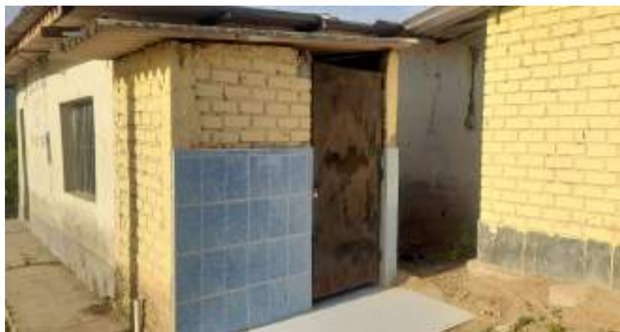
Fotografía N°04: Se muestra los ss.hh. de material noble en malas condiciones.
