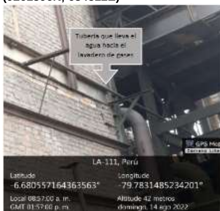
Fotografía N° 4: Tubería que lleva el agua hacia el lavadero de los gases. (14/08/2022) coordenadas UTM WGS84 (9261396N, 634512E)
