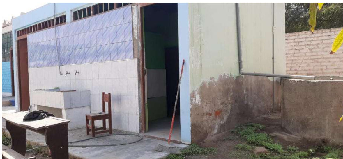
Fotografía N°07: modulo de baño con techo liviano, presencia de humedad en la base perimetral
