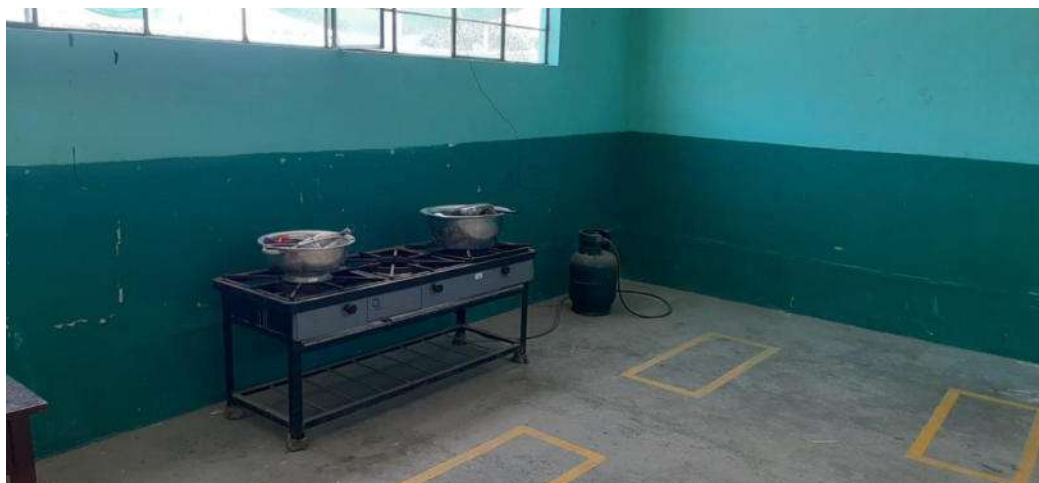
Fotografía N° 08: cocina ubicada temporalmente dentro de un aula, no cumple con las condiciones necesarias para su adecuado funcionamiento.
