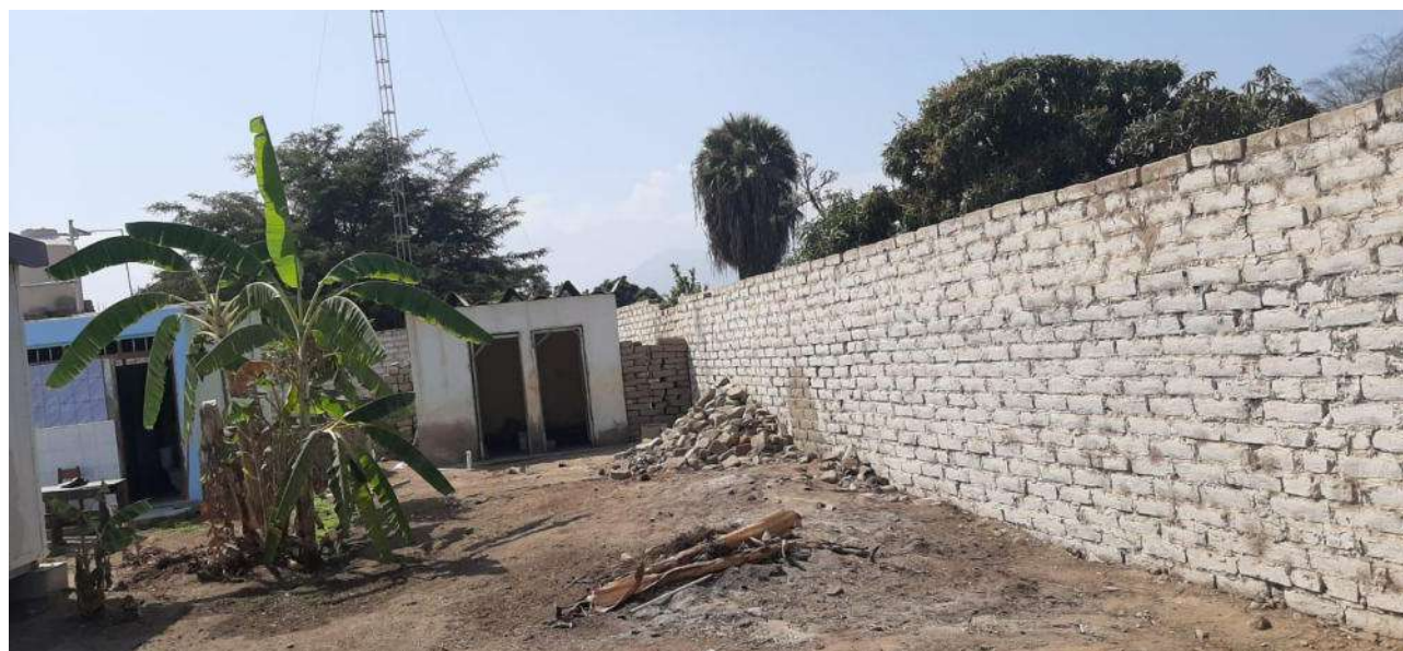
Fotografía N°06: cerco de adobe, sin elementos de sostenimiento
