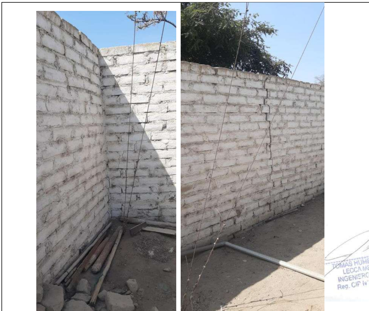
Fotografía N°5: cerco de adobe en mal estado, con presencia de grietas y separación de paños
