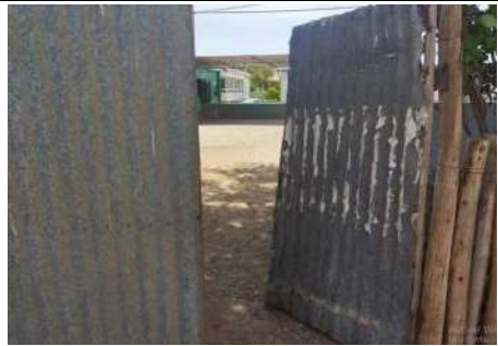
VISTA FRONTAL DE LA I.E. N° 88122, PUERTA PRECARIA EXISTENTE
