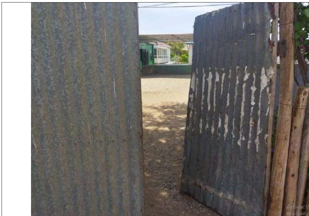
Fotografía N°05: La institución educativa cuenta con un portón en condiciones precarias, en la zona de ingreso.
