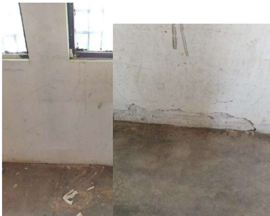
Fotografía N°04: Se visualiza grietas en menor proporción en ambientes de aula.
