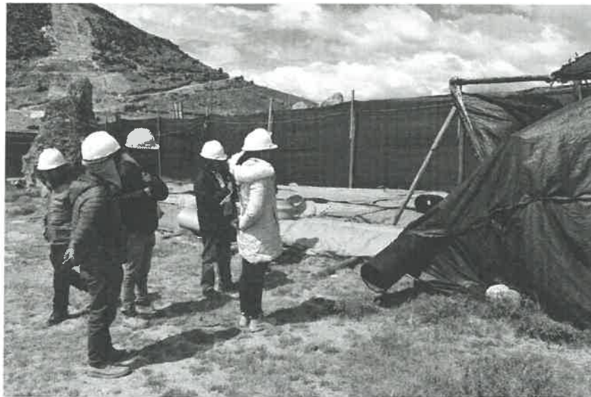
Imagen N° 01 Almacenamiento Inadecuado de Varillas de Acero Corrugado y Tubería HDPE
