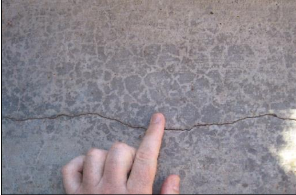
Figura 36: Fisura típica por contracción plástica (PCA)
