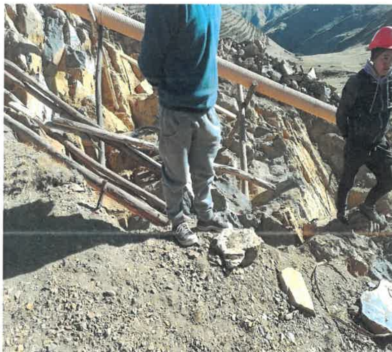
Vistas fotográficas en la que se constató laborar al personal obrero sin contar con los Equipos de Protección Personal - EPP.
