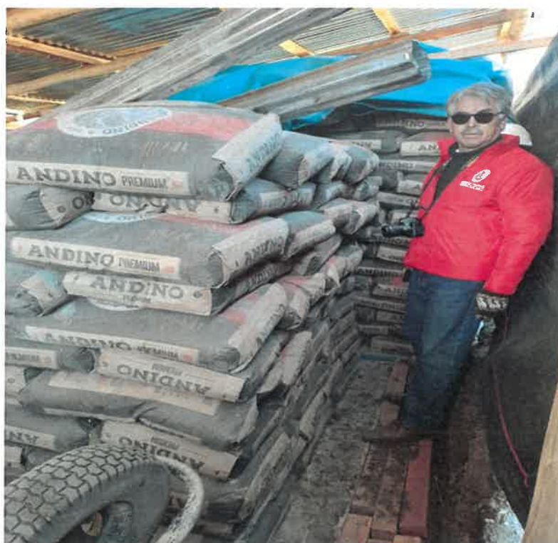
Vistas fotográficas del almacenamiento de Cemento Andino en almacén de obra.
