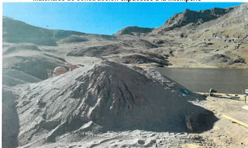
Inadecuado almacenamiento de agregados
