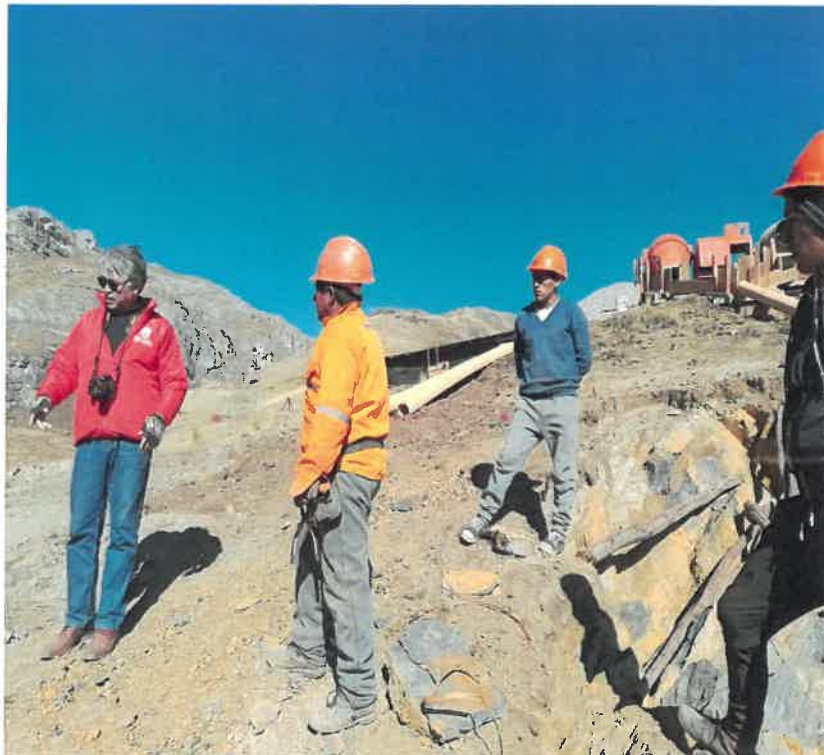
Inadecuado almacenamiento de tubos de plástico.
