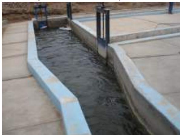
Imagen N°070 Canal de aquietamiento
