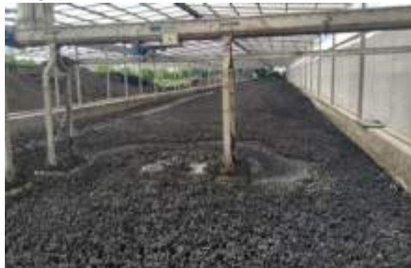
Imagen N°051 Secado de Lodos PTAR Escalerilla
