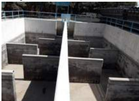
Imagen N°058 Cámara de contacto de cloro
