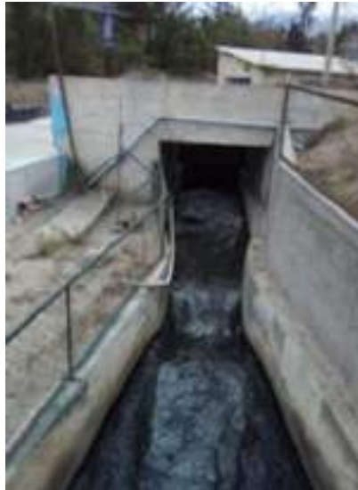
Imagen N°016 7Parshall en la Toma Tomilla
