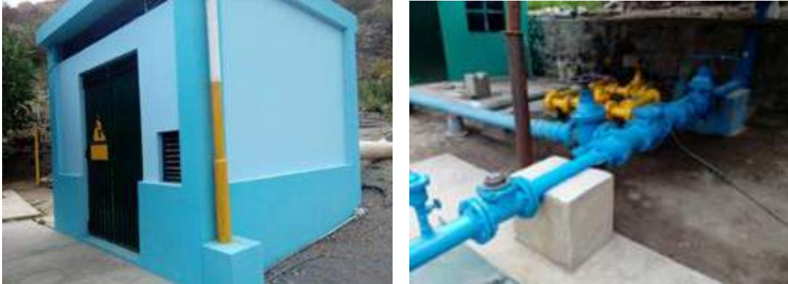
Imagen N°040 Cámara de Bombeo de Nueva Alborada
