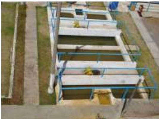
Imagen N°077 Canaleta Parshall de 9" de garganta
