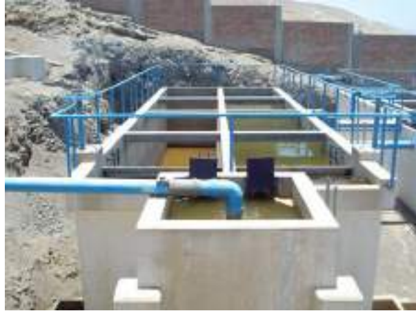
Imagen N° 119 Floculador hidráulico horizontal
