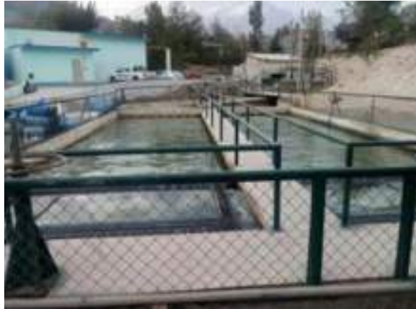
Imagen N°020 Vista de desarenadores
