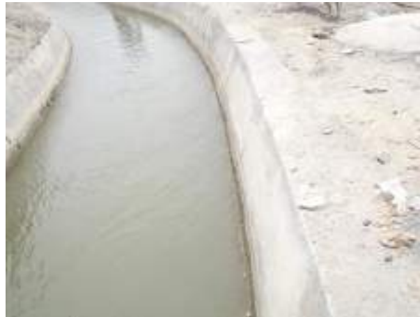
Imagen N°115 Ubicación de válvula en captación de Canal Ensenada Mejía Mollendo
