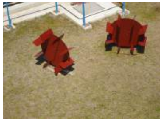
Imagen N°078 Turbinas de floculador mecánico
