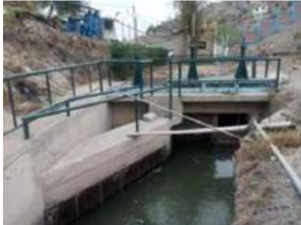
Imagen N°015 Captación canal Zamácola
