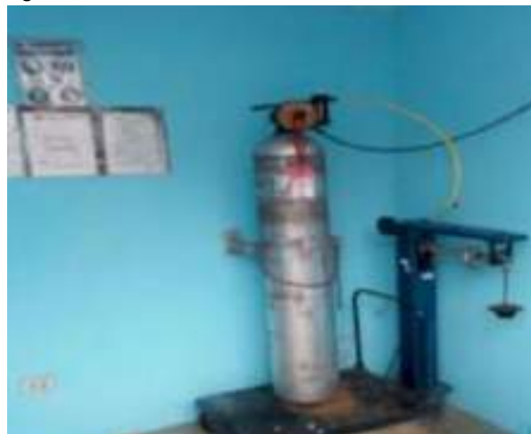
Imagen N°038 Clorador de la Cámara de bombeo CB-8
