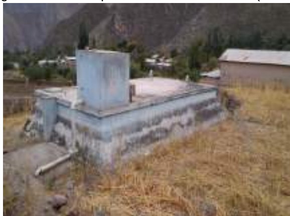
Imagen N°152 Vista panorámica del reservorio(humedad)
