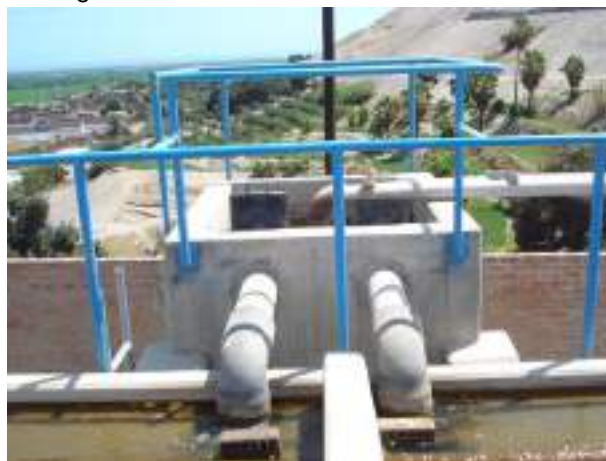
Imagen N° 104: Floculador hidráulico horizontal
