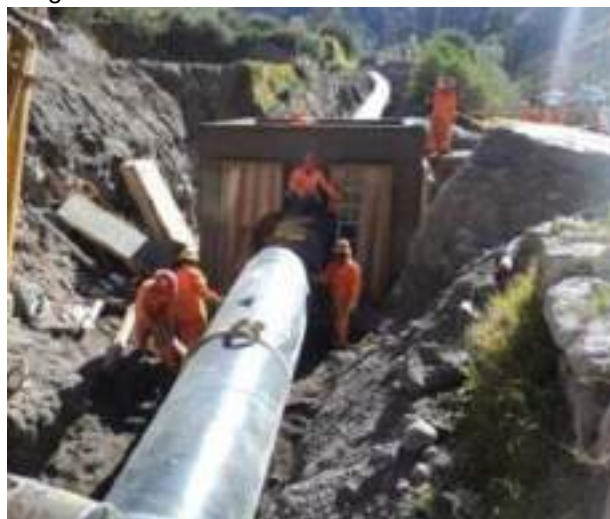
Imagen N°010 Cámara de la válvula N° 2 PTAP MCI
