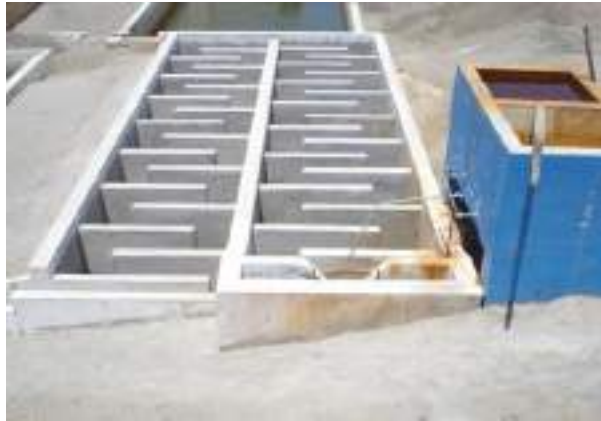
Imagen N°094 Floculador Hidráulico Horizontal
