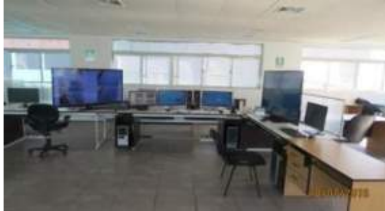
Imagen N°013 Figura Sala SCADA PTAP MCI
