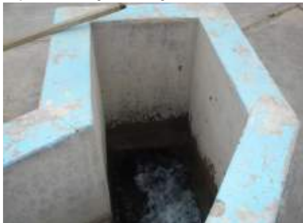
Imagen N°072 Ingreso de agua cruda a tubería de 18"
