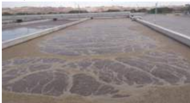
Imagen N°047 Reactor Biológico PTAR Escalerilla
