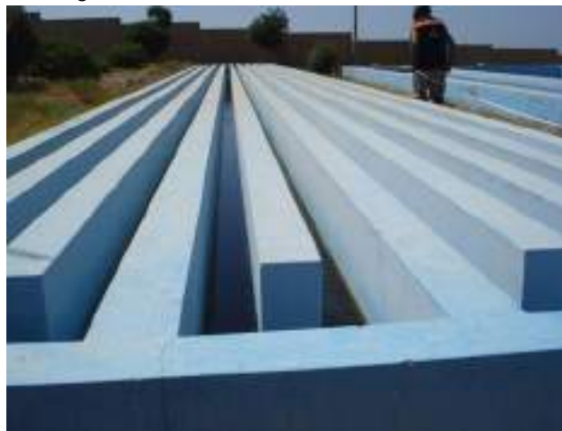
Imagen N° 132: Floculador hidráulico horizontal
