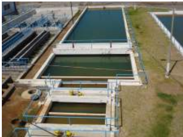
Imagen N°080 Decantador N° 3 con su respectivo floculador
