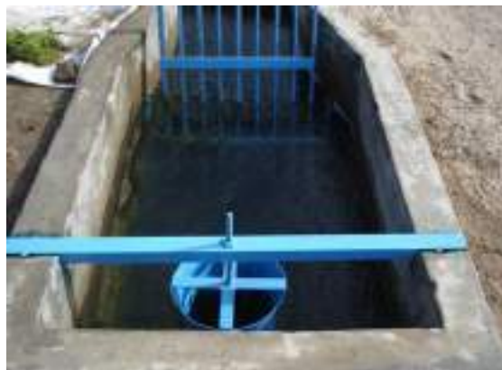
Figura N°074 Captación Planta tubería AC tubería fierro dúctil
