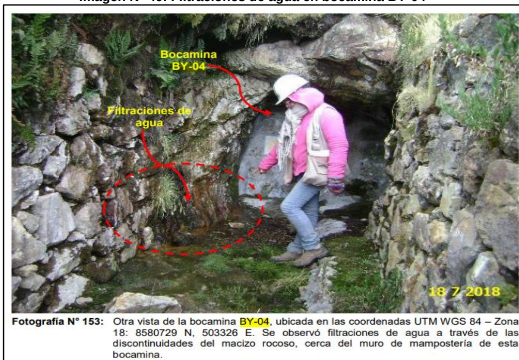
Imagen N° 49: Filtraciones de agua en bocamina BY-04
