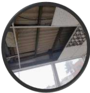
DETERIORO DEL TECHO
