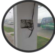
CABLES ELECTRICOS EN DETERIORO
