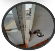
ESTRUCTURAS METALICAS OXIDADAS
