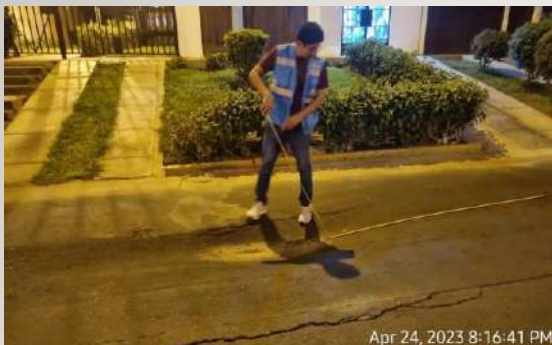
Hundimiento del pavimento ocasionado por trabajos de alcantarillado de Sedapal
