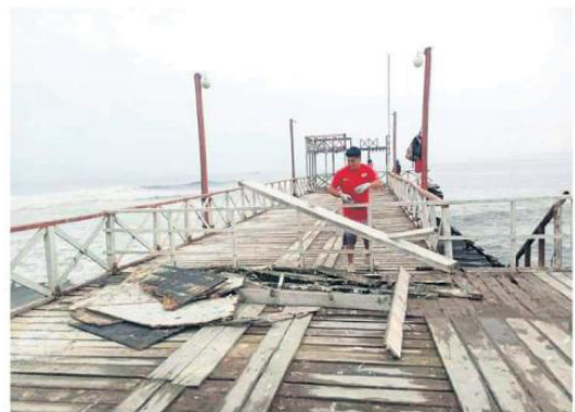
EN PELIGRO. Oleajes anómalos destruyeron el muelle.
