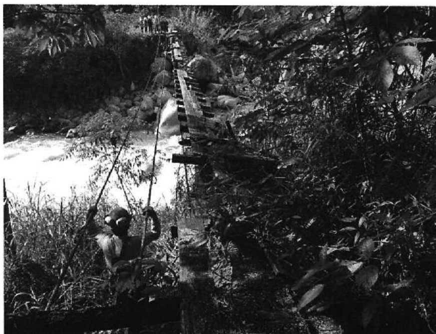
Fotografía 2.3.1-3: Estado actual del Puente de acceso a Ventana "0"
