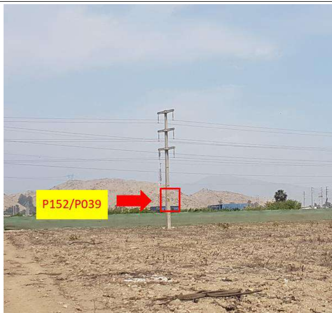
Figura 6.- 9.- Poste P039/P152 Doble Circuito
