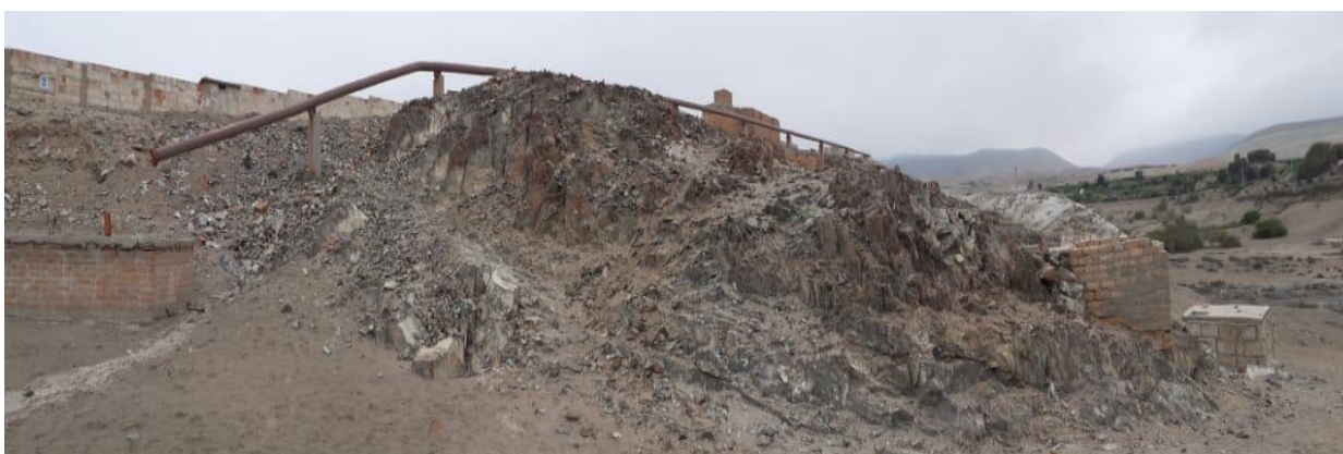
Fotografía N°8: Tubería que se encuentra encima del afloramiento del Gneis, se ubica un riesgo geológico de desprendimiento y deslizamiento del afloramiento.
